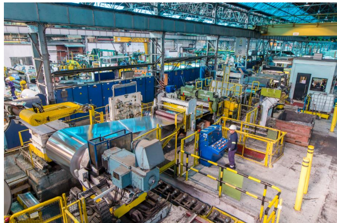
Ilustración 46: Aplanadora bajo tensión (AB1)
