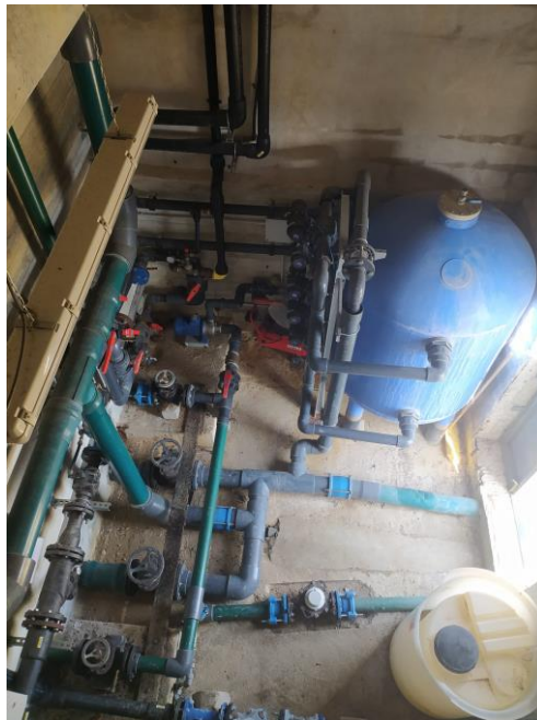
Figura 24. Depósito de cloración
