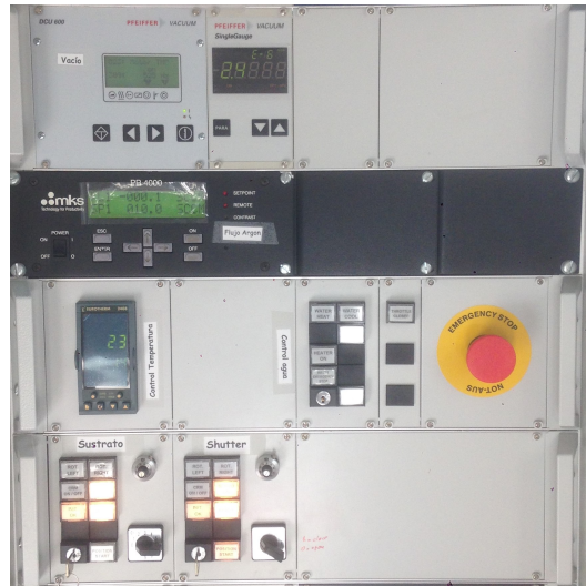
Figura 16: Panel de control del sistema
