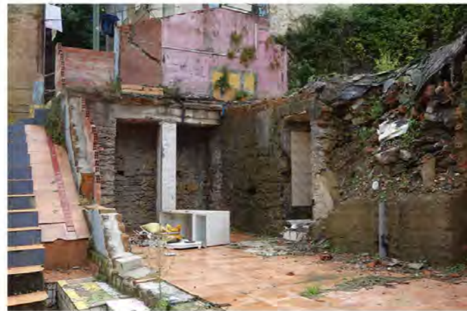
Derribo de viviendas autoconstruidas en Gardexabal, verano del 2018 bajo el régimen de Aharu.
