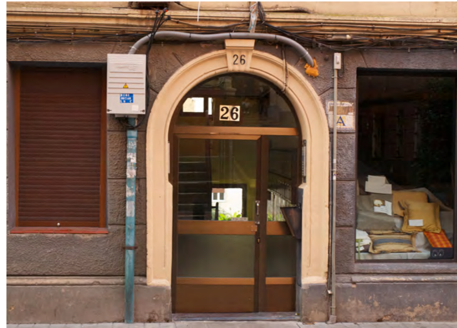
Portal de la barriada donde a mano derecha se ve el deterioro de una de las placas
