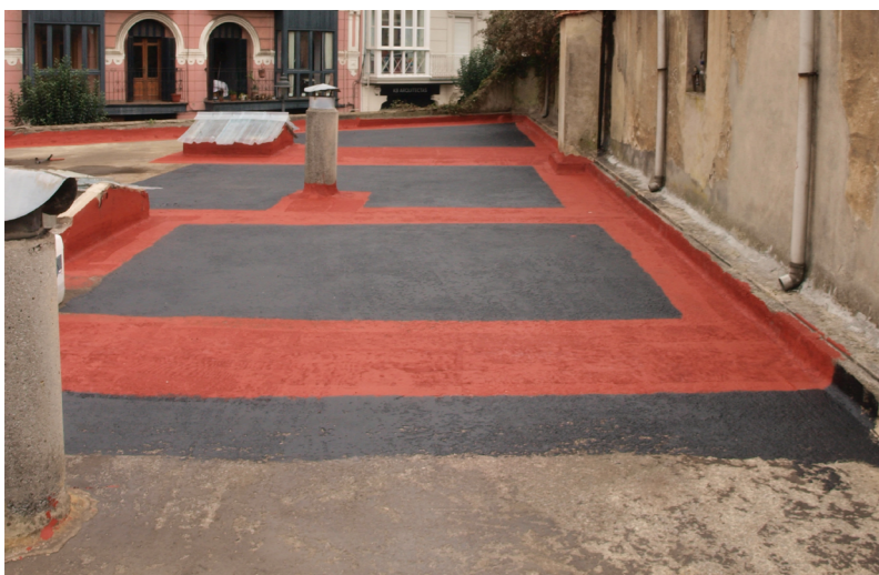
Resultado tras la rehabilitación, limpieza, impermeabilización y sustitución de tragaluces en la cubierta del edificio de nuestro taller
