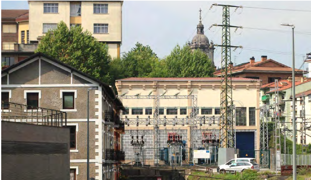
3. argazkia: 11505-B-01 subestazioa.
