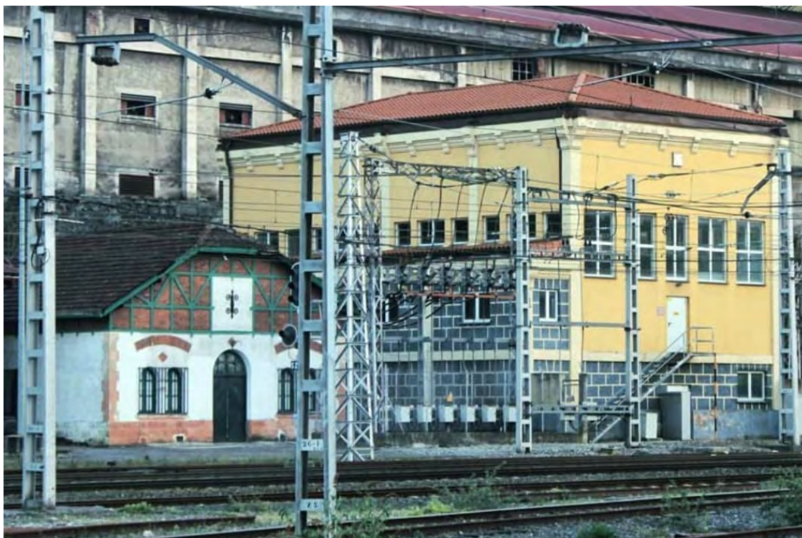
2. argazkia: 11400-B-02 eta 01 eraikinak, subestazio elektrikoa osatzen dutenak.
