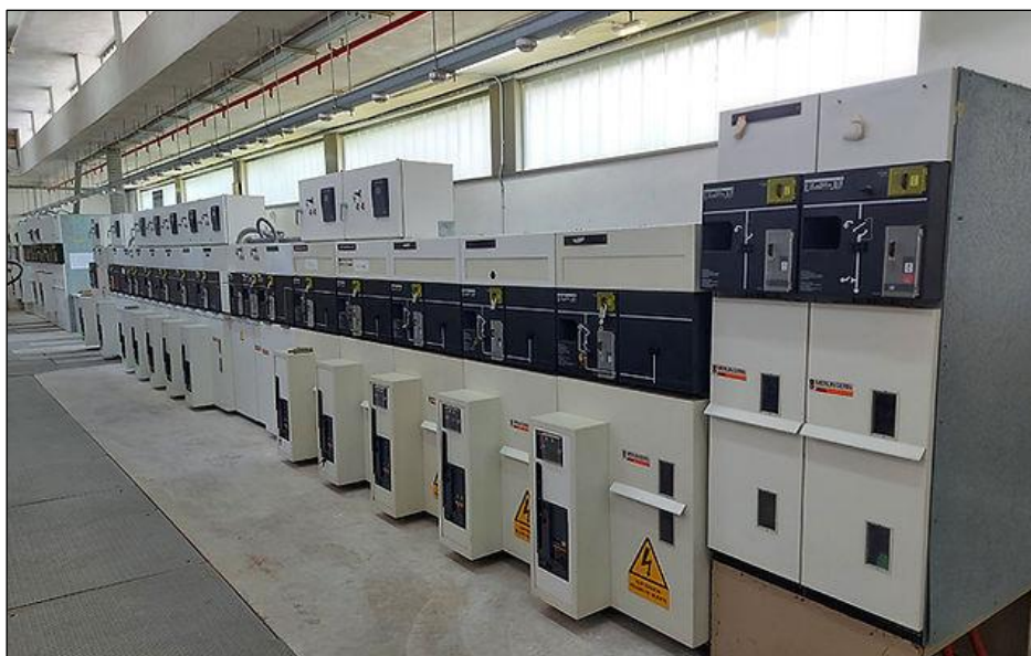
Figura 2. Subestación de la empresa pública (Tolargi) en Tolosa. Fuente: [15].
