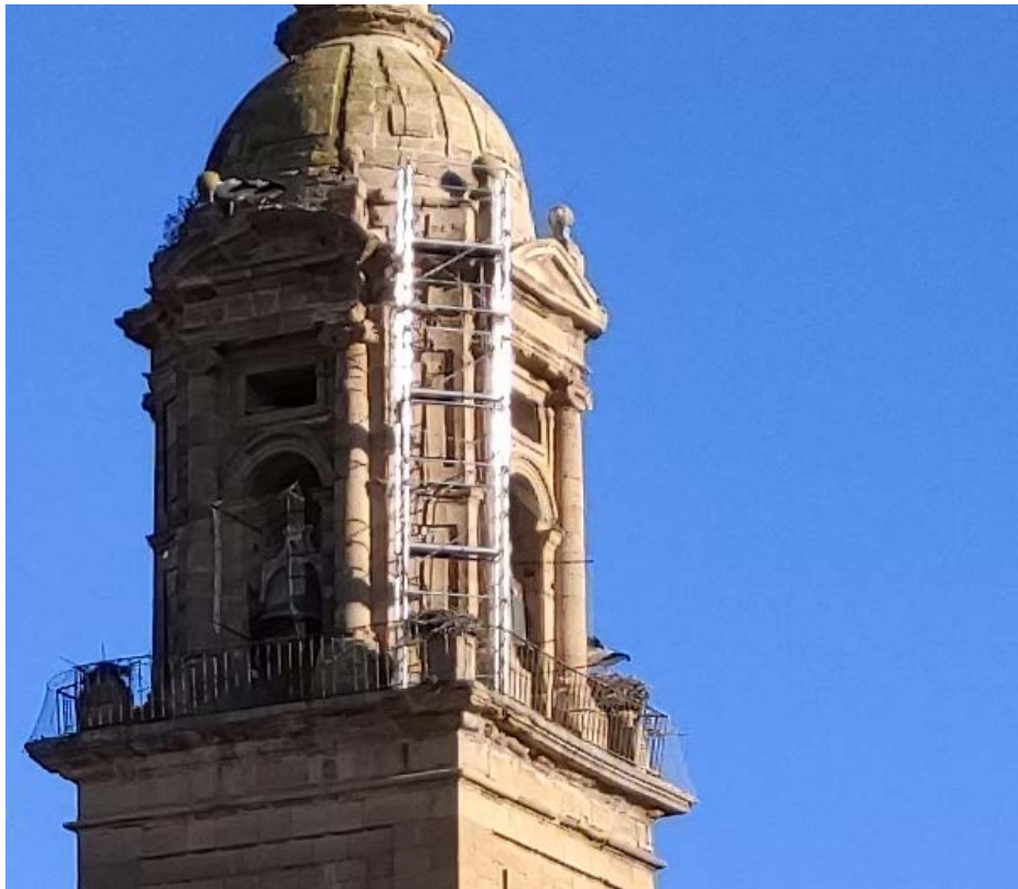
Figura 9. Andamios que impedían la visión de las señales [D1] y [C1] en la campaña de enero de 2022.
