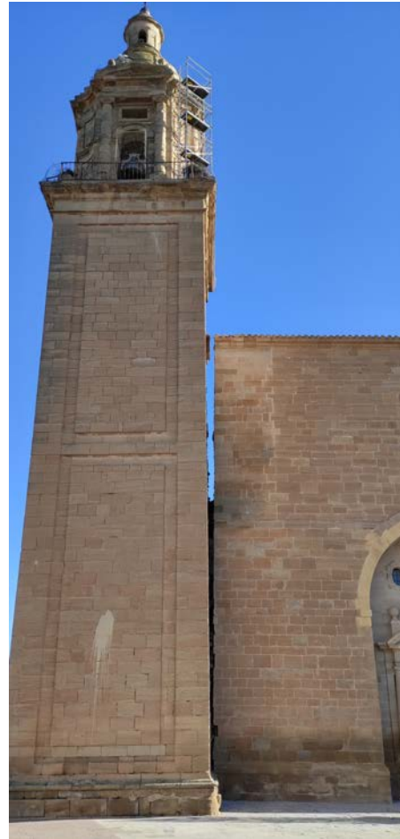
Figura 1. Torre de la iglesia de Santa María de la Blanca, en Agoncillo (La Rioja). Presenta una inclinación de unos 2° (sexagesimales) con respecto al cuerpo de la iglesia.
