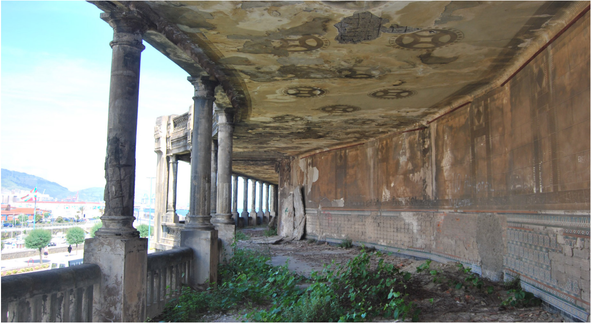
[Fig.57] Crujía de falso techo de hormigón caída (Fotografía de elaboración propia, julio de 2015)
