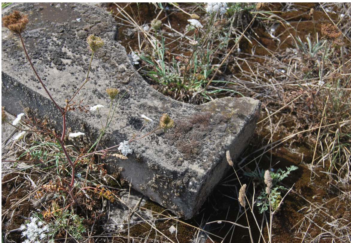
[Fig.78] Ausencia de armadura de nexo entre piezas (Fotografía de elaboración propia, agosto de 2017).
