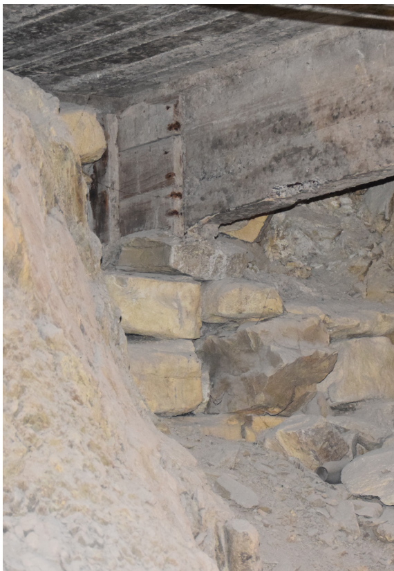
[Fig.19] Restos de encofrado (Fotografía de elaboración propia, agosto de 2017).
