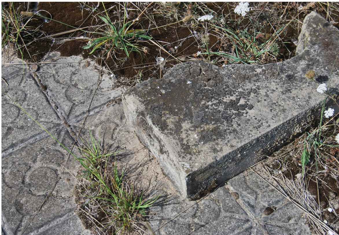
[Fig.77] Ausencia de armadura de nexo entre piezas (Fotografía de elaboración propia, agosto de 2017).
