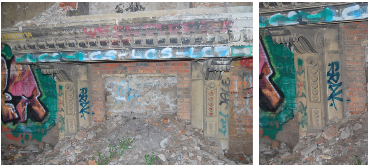
[Fig.24] Estado actual de la chimenea (Fotografías de elaboración propia, agosto del año 2015).
