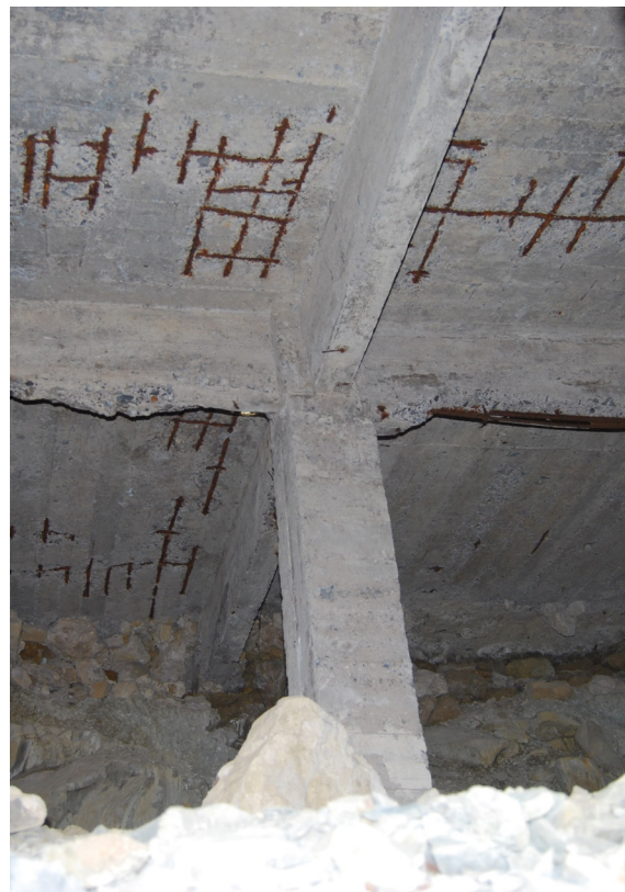
[Fig.10] Vigas, pilares y losas del tramo entre crujeas 1 a 20A (Fotografía de elaboración propia, julio de 2017).
