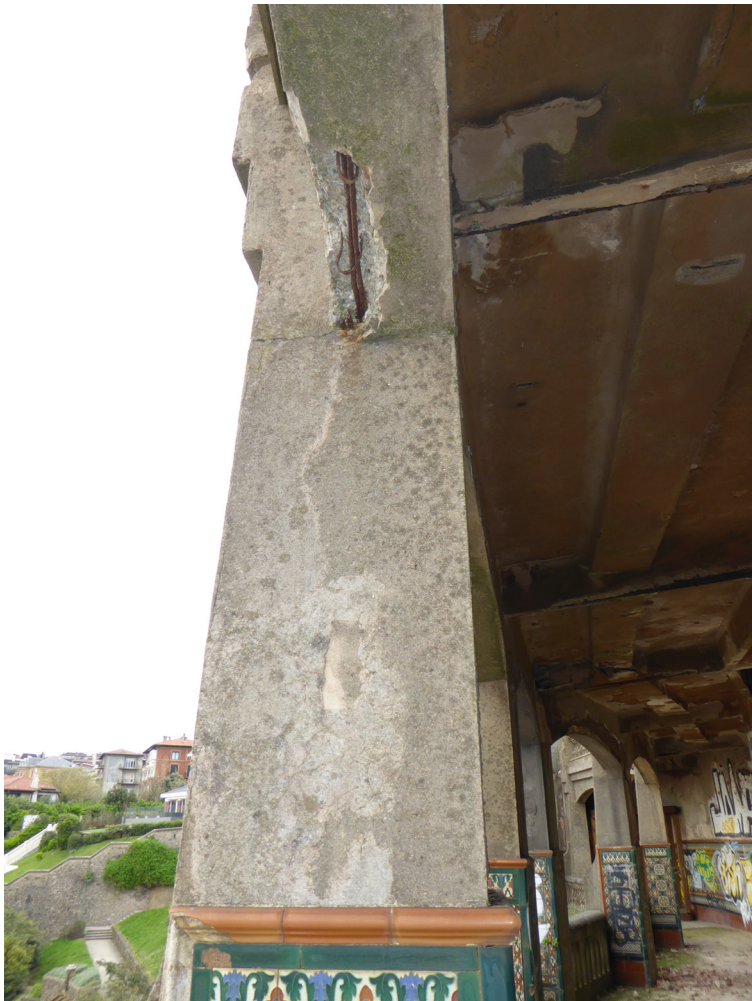
[Fig.20] Viga P.15-P.16 (Fotografía de elaboración propia, junio de 2019). Asimismo, en la presente fotografía se puede apreciar cómo la degradación del hormigón también se manifiesta en las partes externas de las vigas entre crujías.
