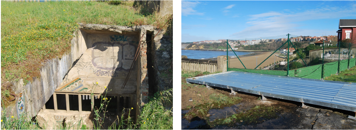
[Fig.3] Situación del acceso tras la demolición de la garita y estado actual cerrado provisionalmente (Fotografías de elaboración propia, junio de 2014 y enero del año 2015 respectivamente).
