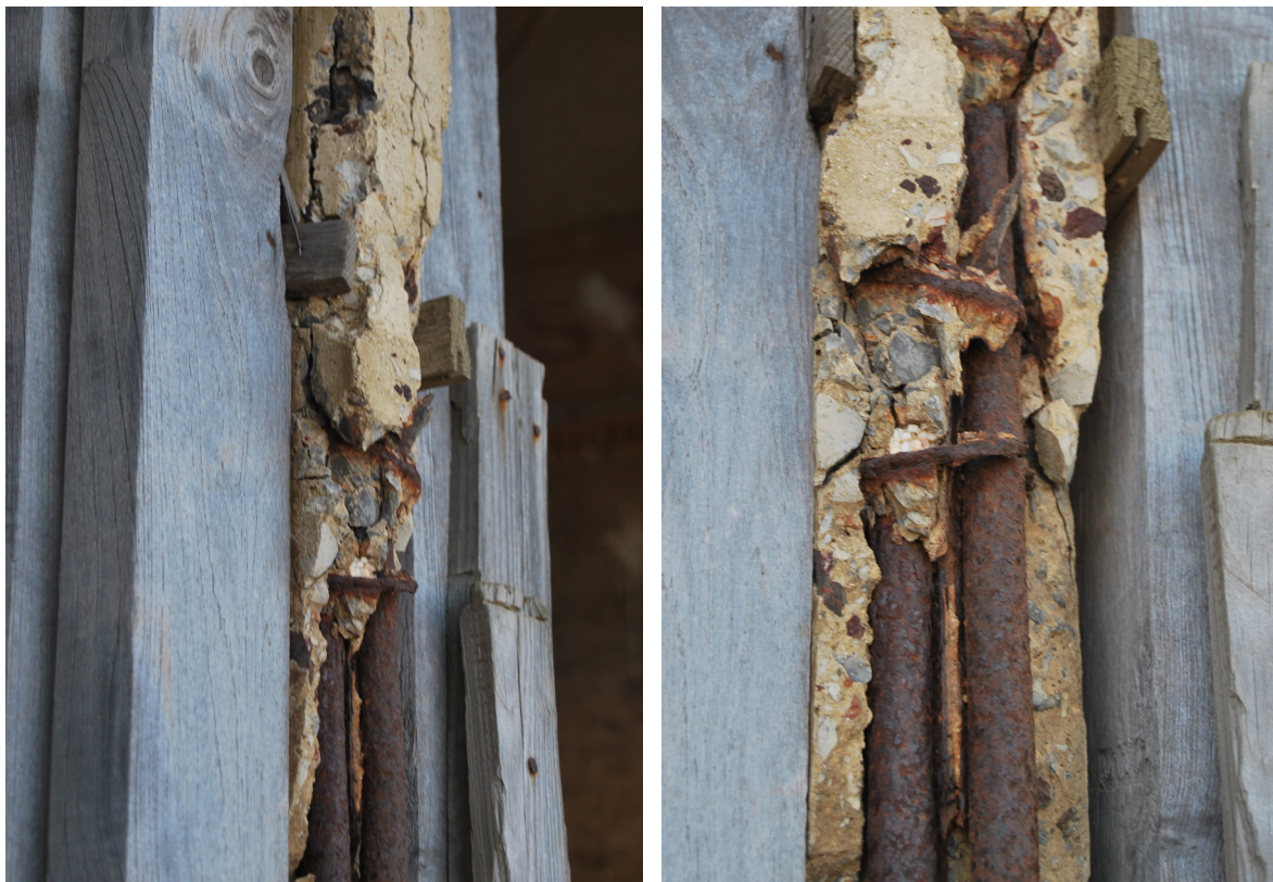
[Fig.81] Carbonatación y rotura de jambas de hormigón (Fotografía de elaboración propia, junio de 2013).
