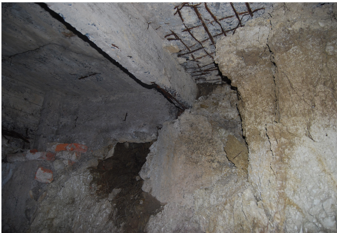
[Fig.82] Apoyo de vigas directamente sobre el terreno (Fotografía de elaboración propia, noviembre de 2016).
