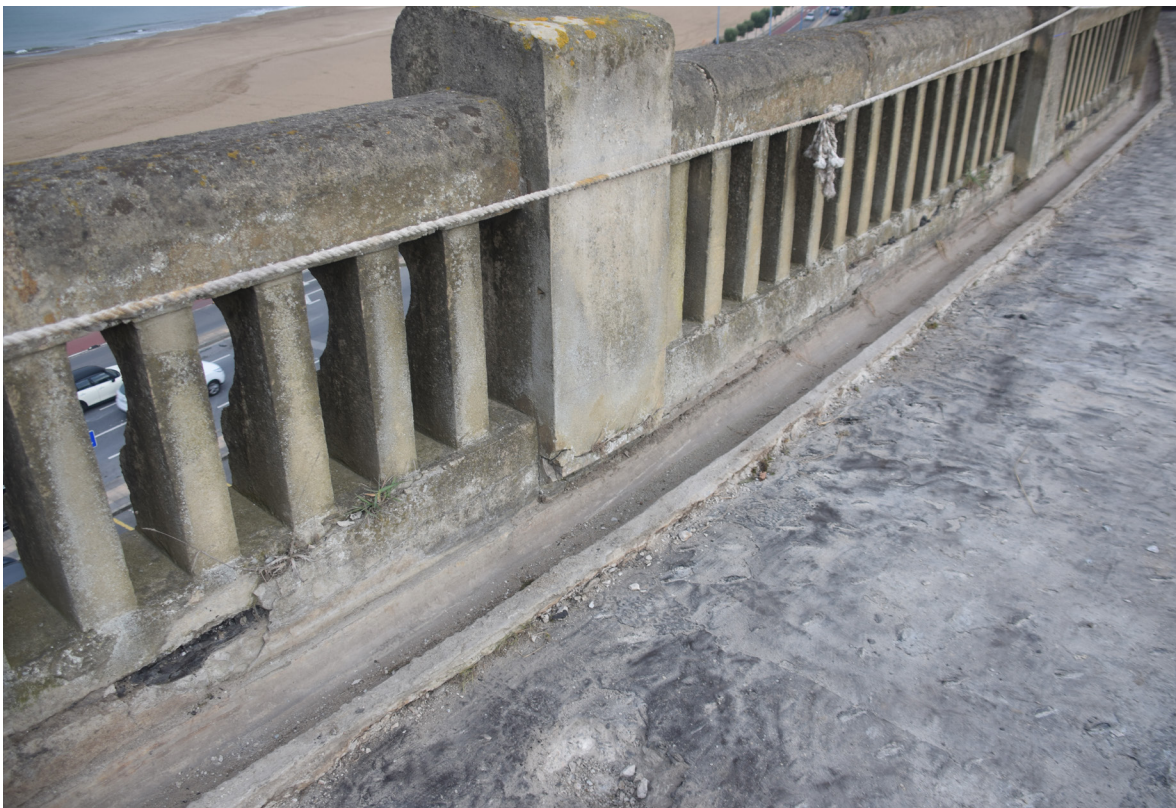
[Fig.27] Rebase del pesebre por la lámina de impermeabilización (Fotografía de elaboración propia, octubre de 2017).
