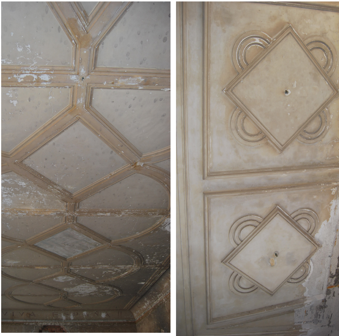
[Fig.21] Estado de los techos del salón y del vestíbulo de la escalera de acceso al mismo (Fotografías de elaboración propia, junio del año 2015).
