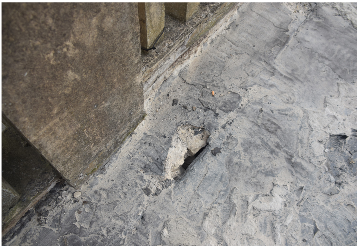
[Fig.70] Ausencia de malla de refuerzo en cambio de material (Fotografía de elaboración propia, octubre de 2017).
