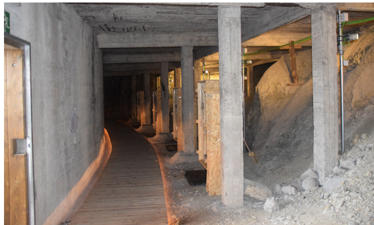
[Fig.14] Descoordinación de los pilares de la carpintería frente a la estructura (Fotografía de elaboración propia, agosto de 2017).
