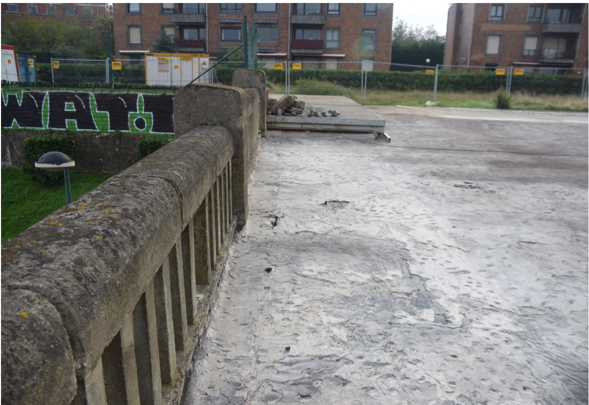
[Fig.72] Ausencia de malla de refuerzo en cambio de material (Fotografía de elaboración propia, octubre de 2017).
