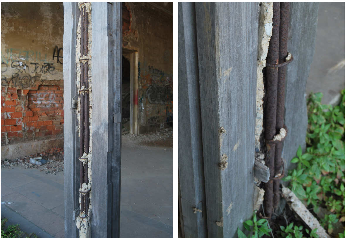
[Fig.80] Carbonatación y rotura de jambas de hormigón (Fotografía de elaboración propia, junio de 2013).
