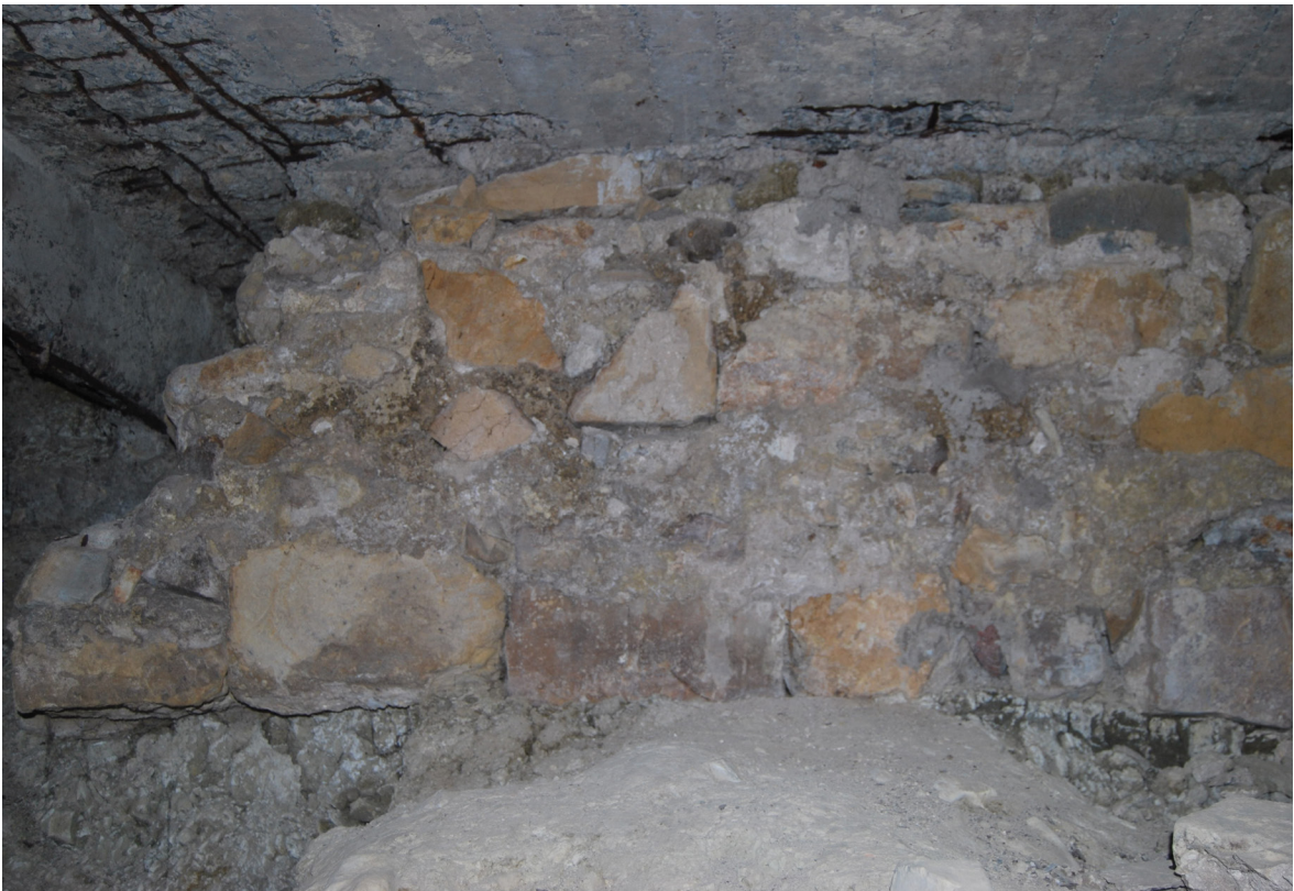
[Fig.84] Apoyo de losa sobre muro preexistente (Fotografía de elaboración propia, noviembre de 2016).
