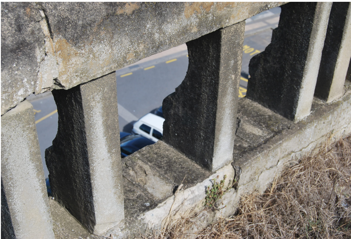
[Fig.76] Ausencia de armadura de nexo entre piezas (Fotografía de elaboración propia, agosto de 2017).
