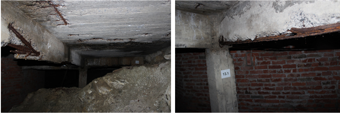
[Fig.21] Vigas P.11.1-P.12.1 y P.12.1-P.13.1 (Fotografías de elaboración propia, junio de 2019).
