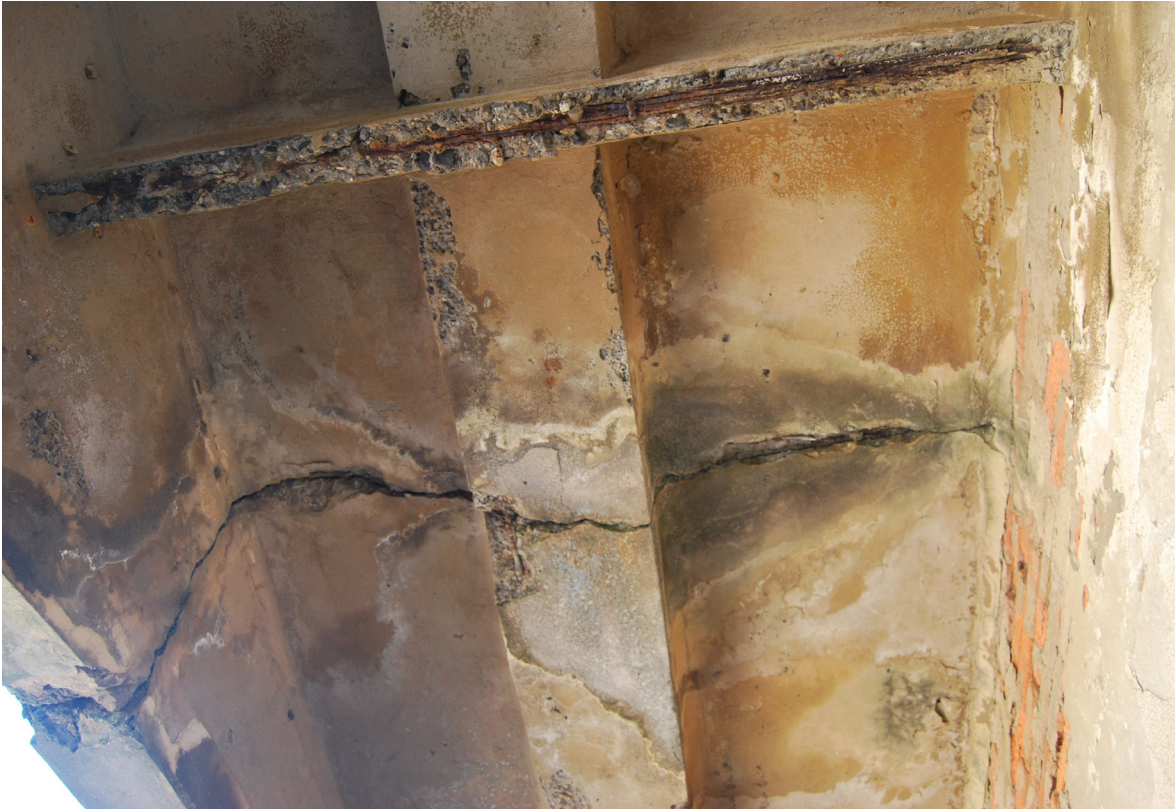
[Fig.87] Falta de recubrimiento y grieta (Fotografía de elaboración propia, junio de 2018).
