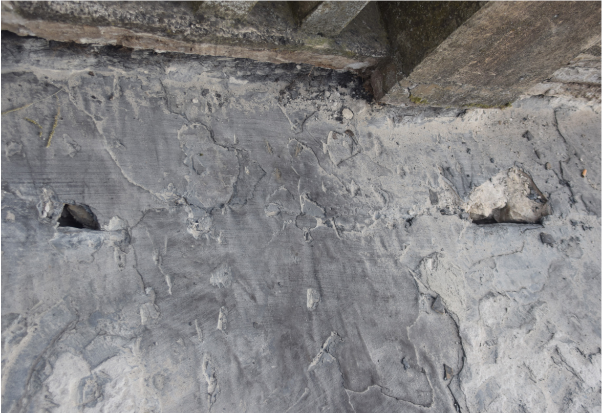
[Fig.71] Ausencia de malla de refuerzo en cambio de material (Fotografía de elaboración propia, octubre de 2017).
