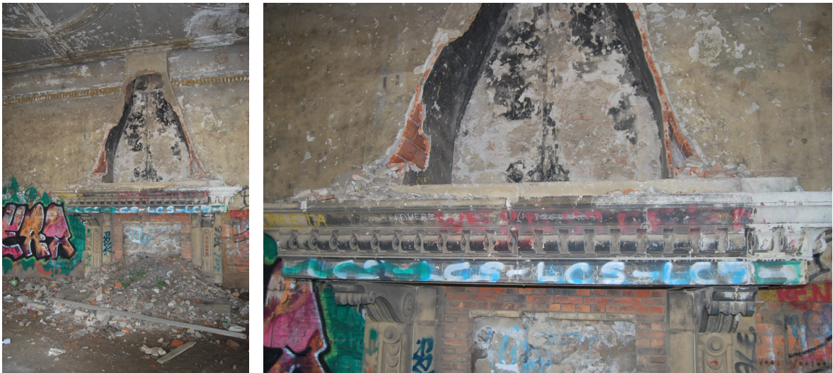
[Fig.23] Estado actual de la chimenea (Fotografías de elaboración propia, agosto del año 2015).
