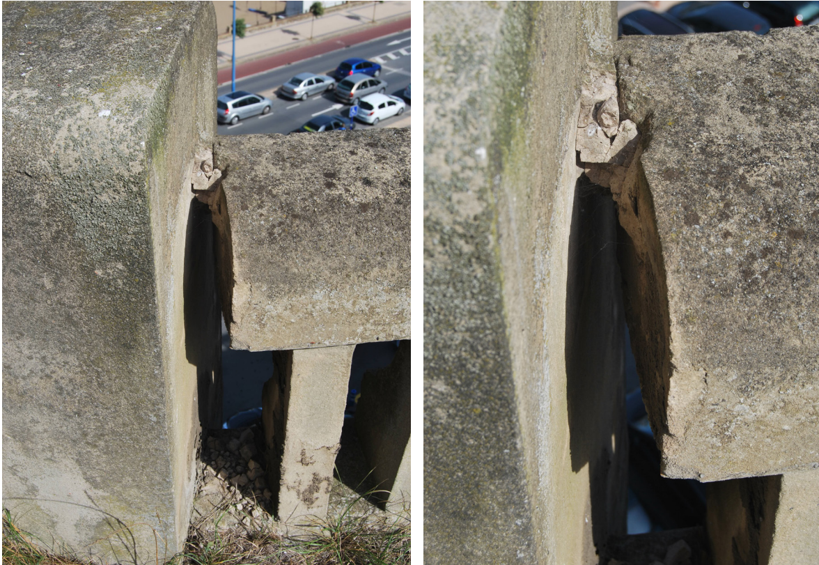
[Fig.75] Ausencia de pieza especial y unión con mortero (Fotografía de elaboración propia, agosto de 2017).
