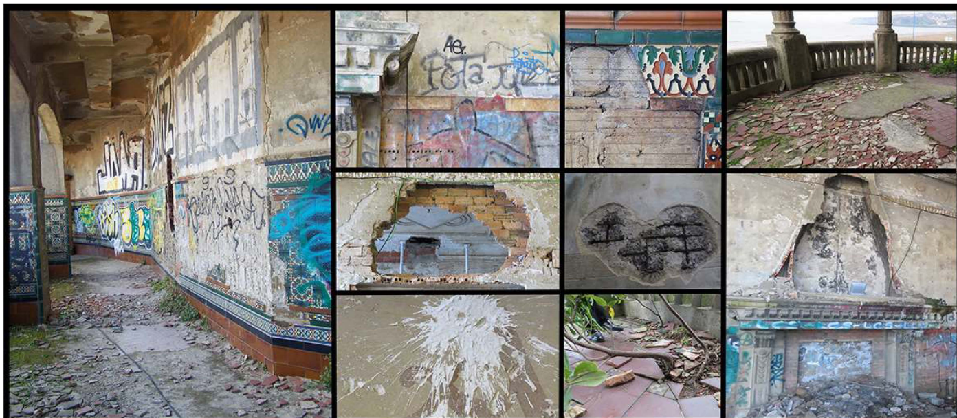
Fig. 3 Ejemplos de deterioros, de izquierda a derecha y de arriba abajo: Vista general de la galería noroeste, grafitis y escoriaciones, butrón, depósitos, pérdida de elementos, desprendimientos por expansión de las armaduras, piezas cerámicas desplazada por el crecimiento de plantas superiores, vista general del Tholos, y vista general de la chimenea
