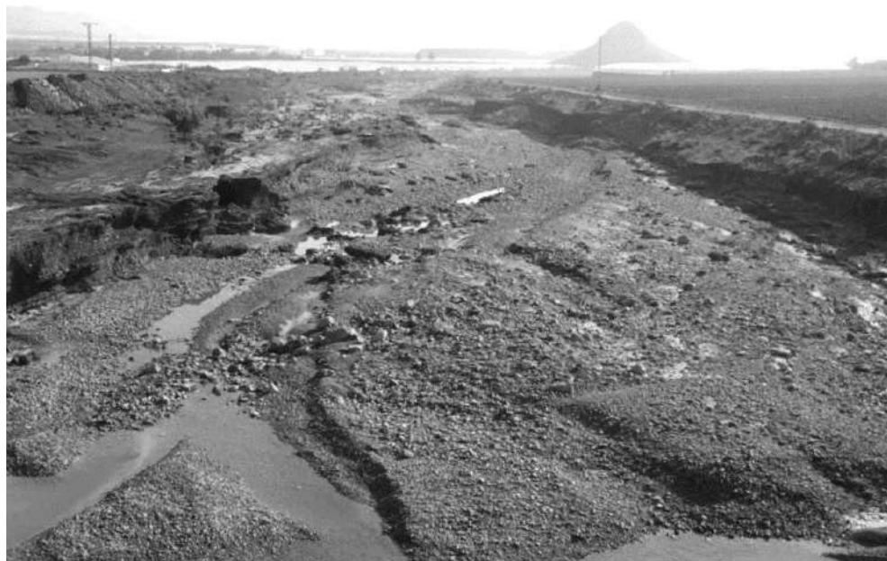
Figura 102. Tramo bajo de la Rambla de las Moreras con lecho de gravas y cantos, fuerte carga de fondo y erosión lateral. Rambla litoral murciana dotada de una importante fuente de sedimentos gruesos en terrenos metamórficos de cabecera.
