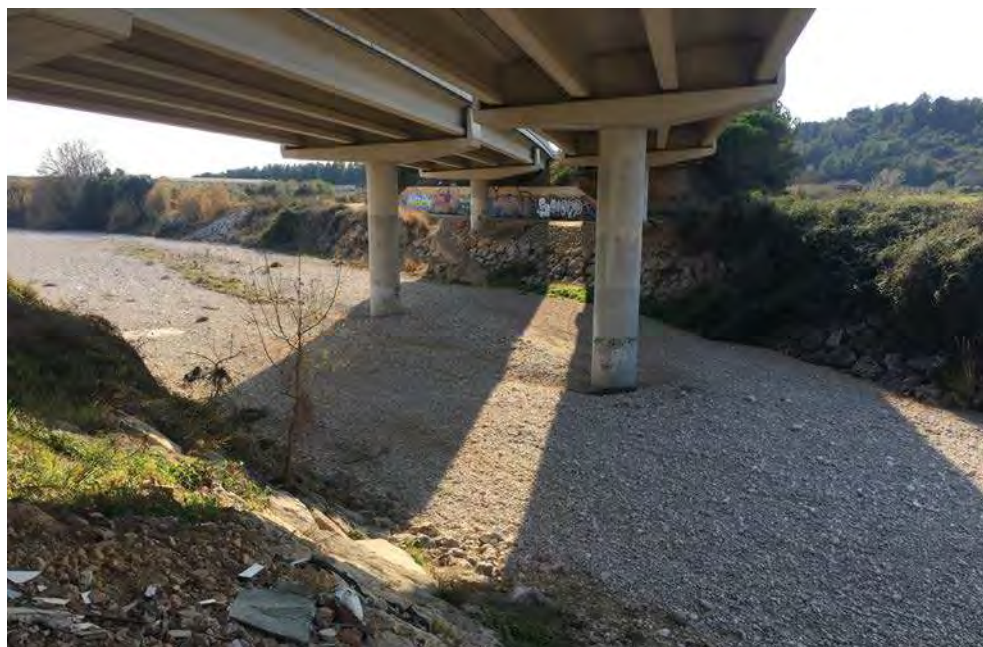
Figura 105. Puente de la C32 sobre el río Foix (Cubelles, Barcelona). Se podría haber evitado el apoyo de pilares en el cauce activo.
