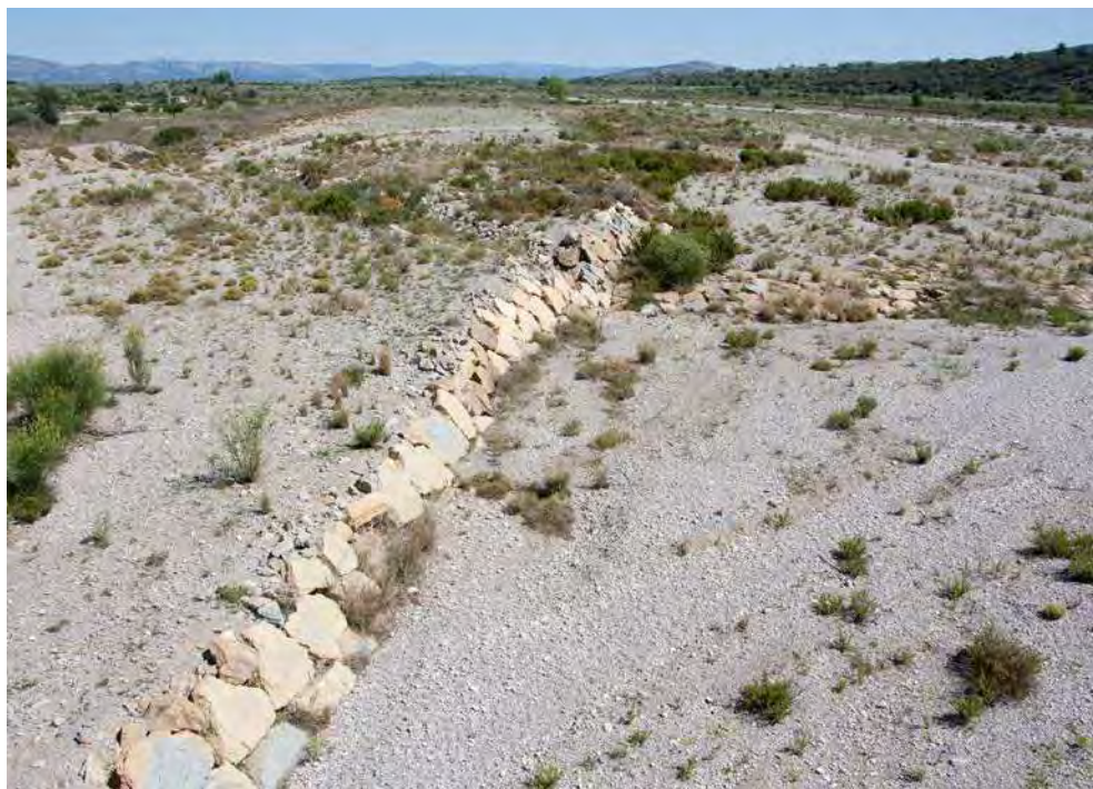
Figura 122. Rambla de Cervera (Sant Mateu, Castelló), con escolleras internas que cortan y restringen el territorio fluvial.
