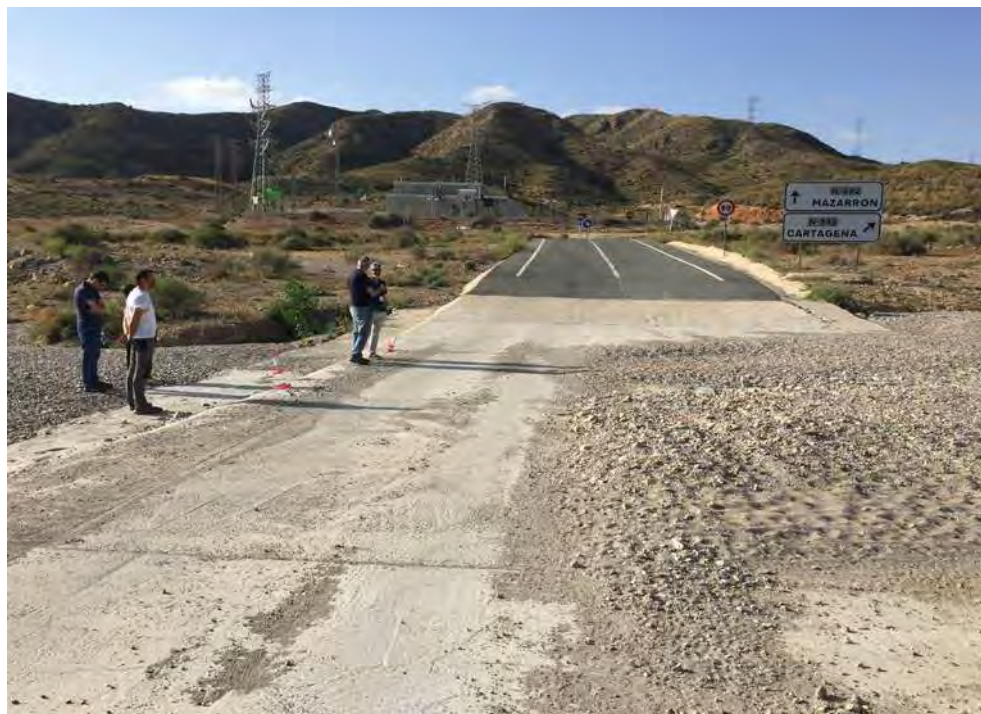
Figura 134. Vado construido en un tramo de cauce especialmente activo de la rambla de Valdelentisco, junto a Isla Plana (Cartagena). Durante las avenidas suele ser paso de una importante carga de fondo (arenas y gravas), con el consiguiente peligro que ello supone para el acceso de vehículos.
