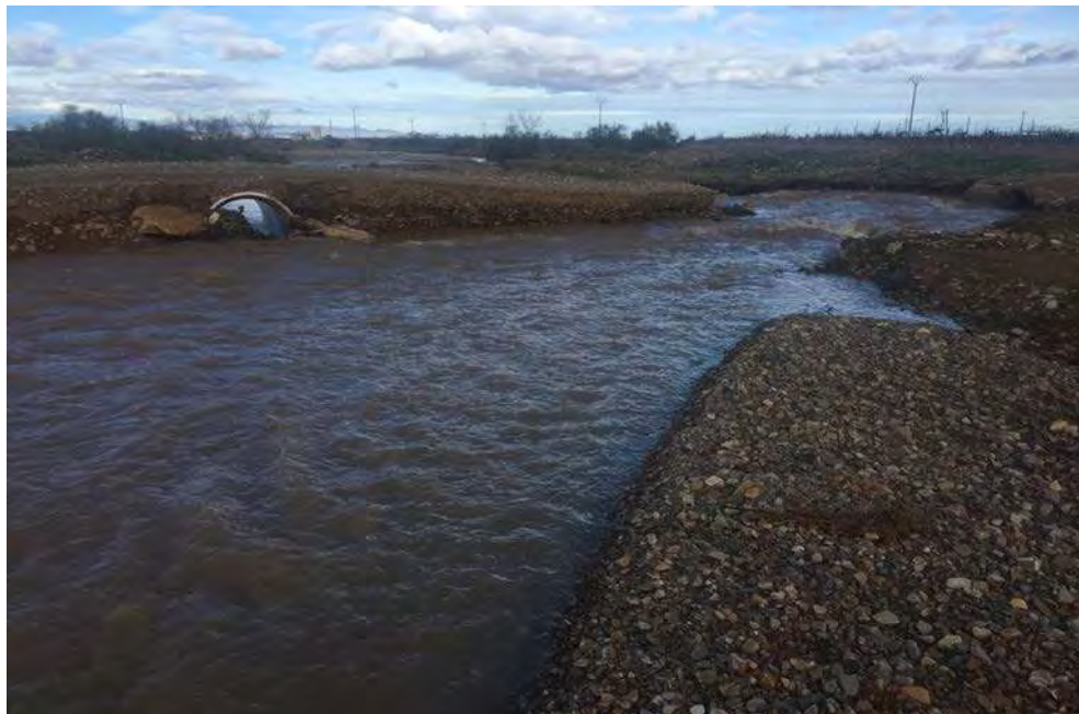
Figura 110. La crecida en la rambla de Cariñena a raíz del episodio Gloria (enero 2020) destruye el vado de la Virgen de Lagunas, resultando inútil el único tubo existente bajo el mismo. Al parecer, este vado es ilegal y son los propietarios locales los que lo rehabilitan por su cuenta tras cada avenida.
