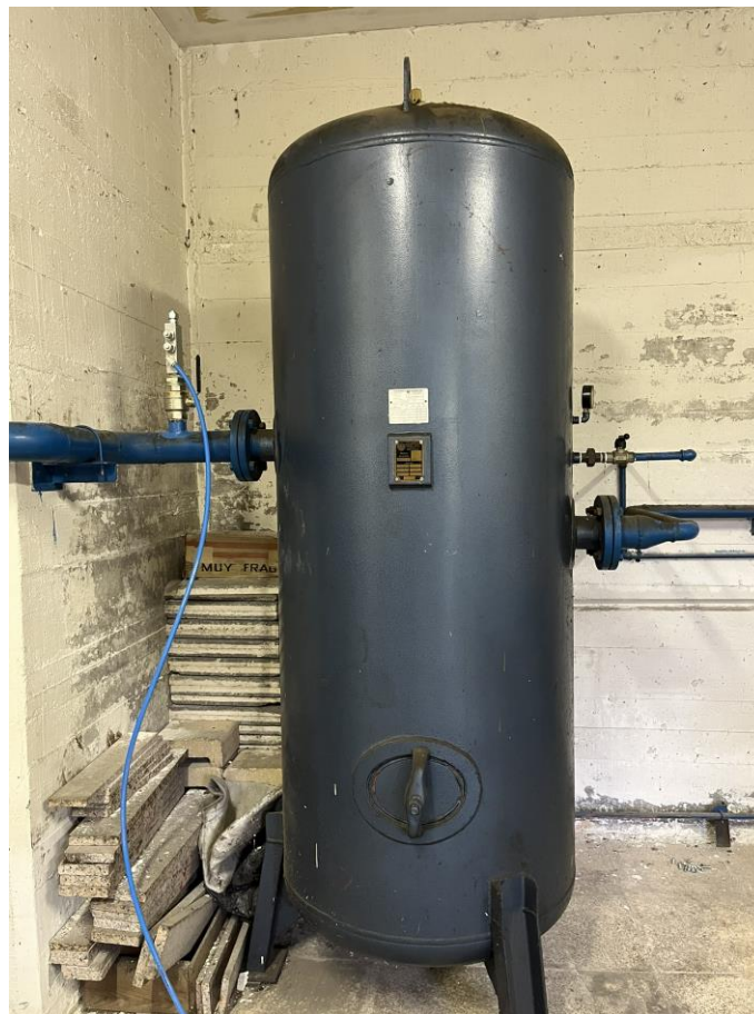
Figura 36. Tanque de aire presurizado.
