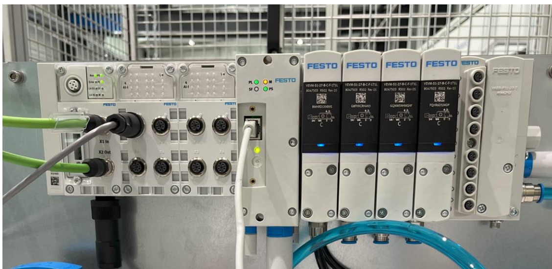
Figura 5. VTEM instalado en el BEC.
