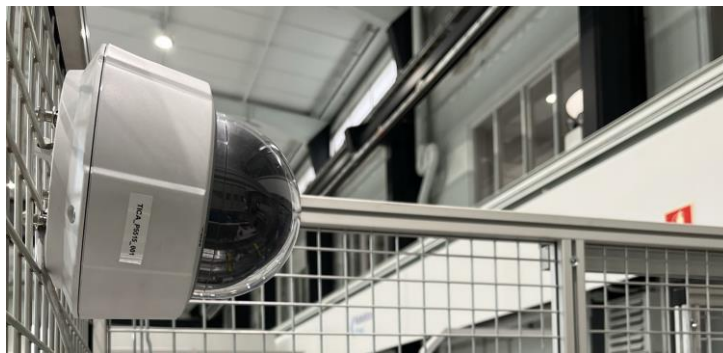
Figura 46. Cámara IP instalada en el banco.
