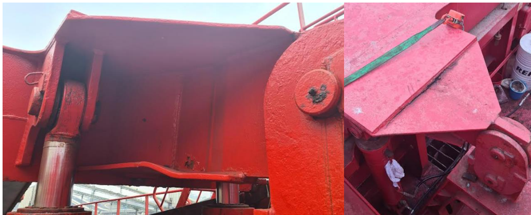
Figura 35: Deformación del acero en pieza de soporte de apertura y cierre de tapas de bodegas del MORAIME
