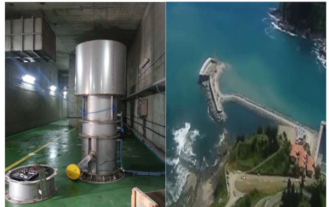
Fig. 1. Irudia. Mutrikuko energia-sorgailuaren moduluak
