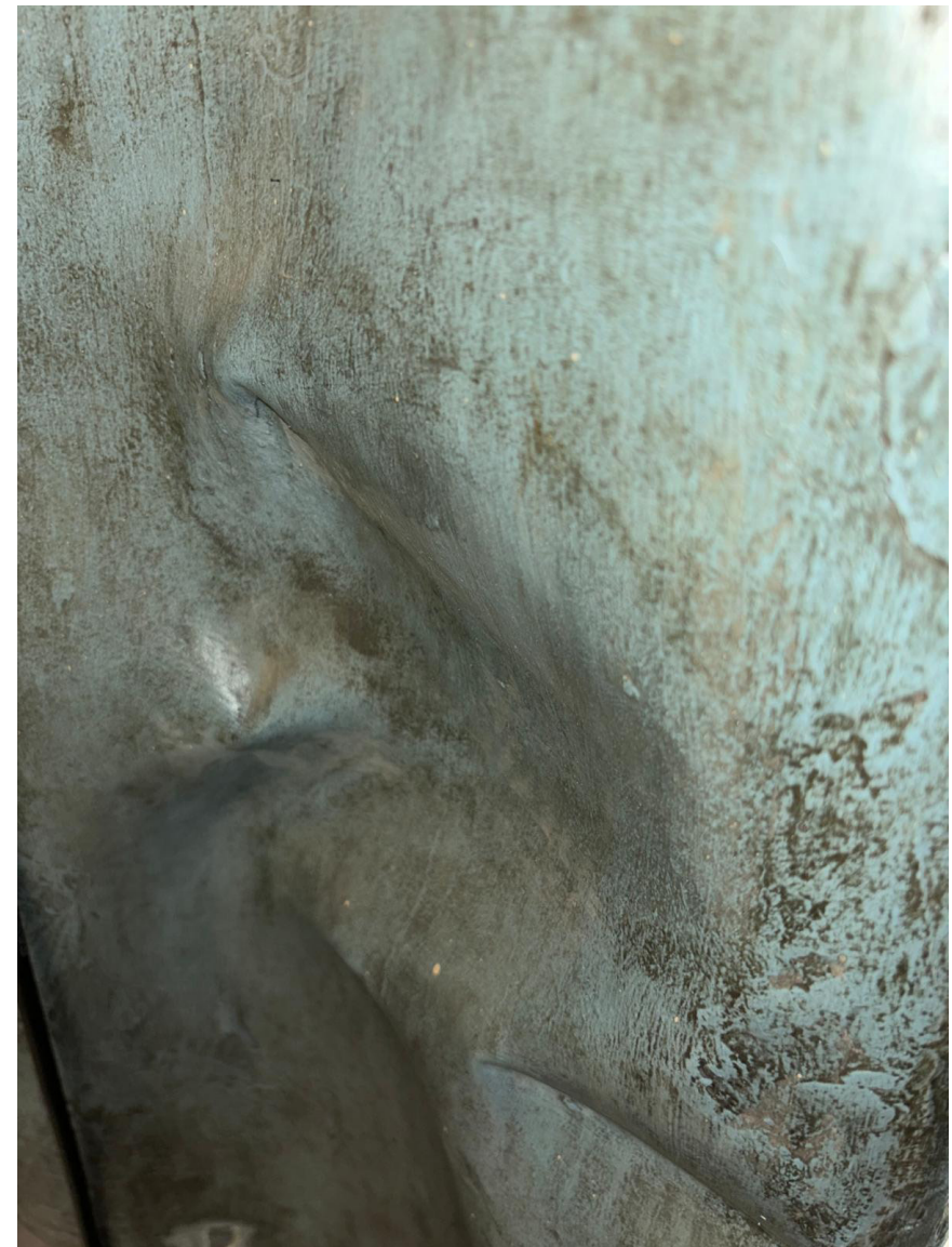
Fig. 4: Detalle de las quebraduras del manto
