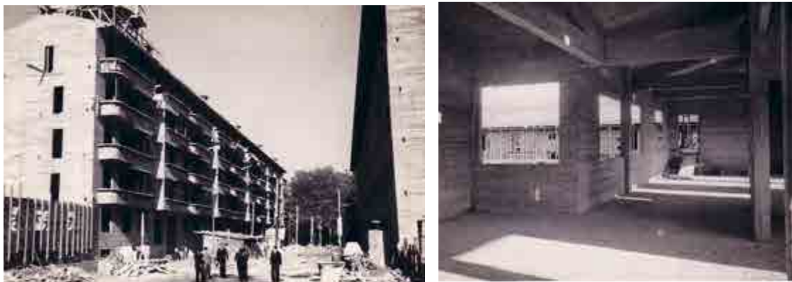
Obras paralizadas del grupo de viviendas municipales de Torre Madariaga.
