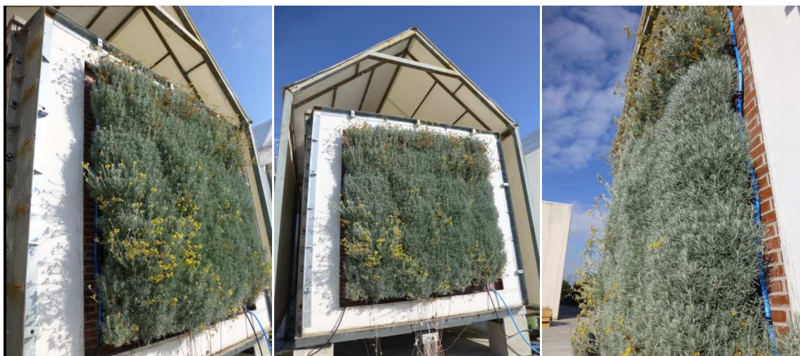
Fig. 4. 20. Detalle de la fachada vegetal en Octubre de 2013 durante el ensayo PRBS en la célula de ensayo ILARGI
