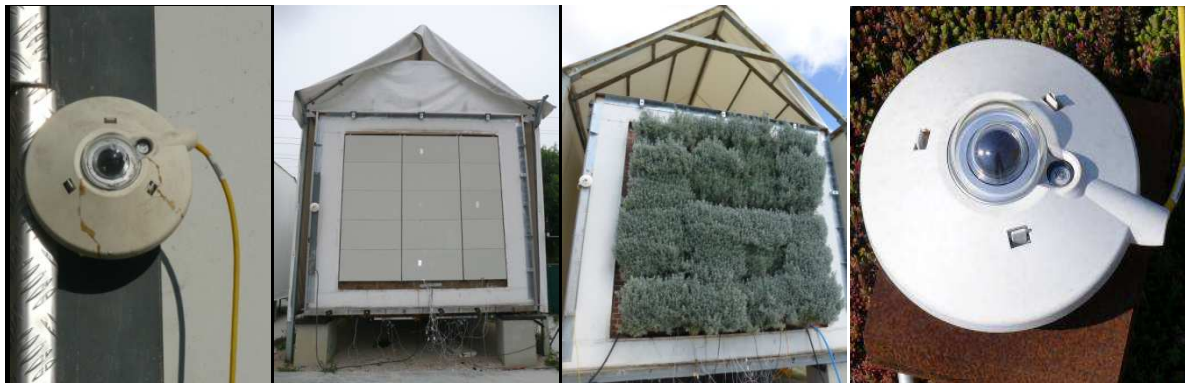
Fig. 3. 26. Detalle de los solarímetros y de su posicionamiento en la fachada ventilada como en la vegetal.
