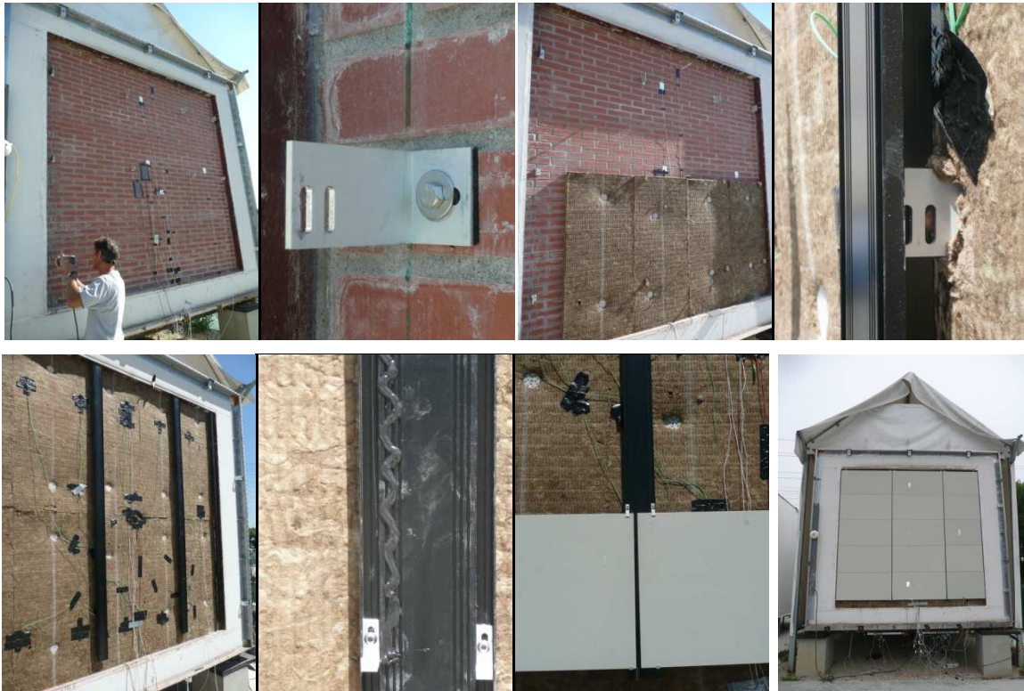
Fig. 3. 9. Detalle gráfico de la instalación de la fachada ventilada. Arriba en primer lugar se muestra la fachada caravista donde se han colocado los anclajes de sustentación. A continuación, se muestran los anclajes utilizados para la lana de roca y su colocación. Abajo, se puede observar la estructura metálica portante anclada a la fachada original y la colocación de las placas cerámicas sobre los portantes
