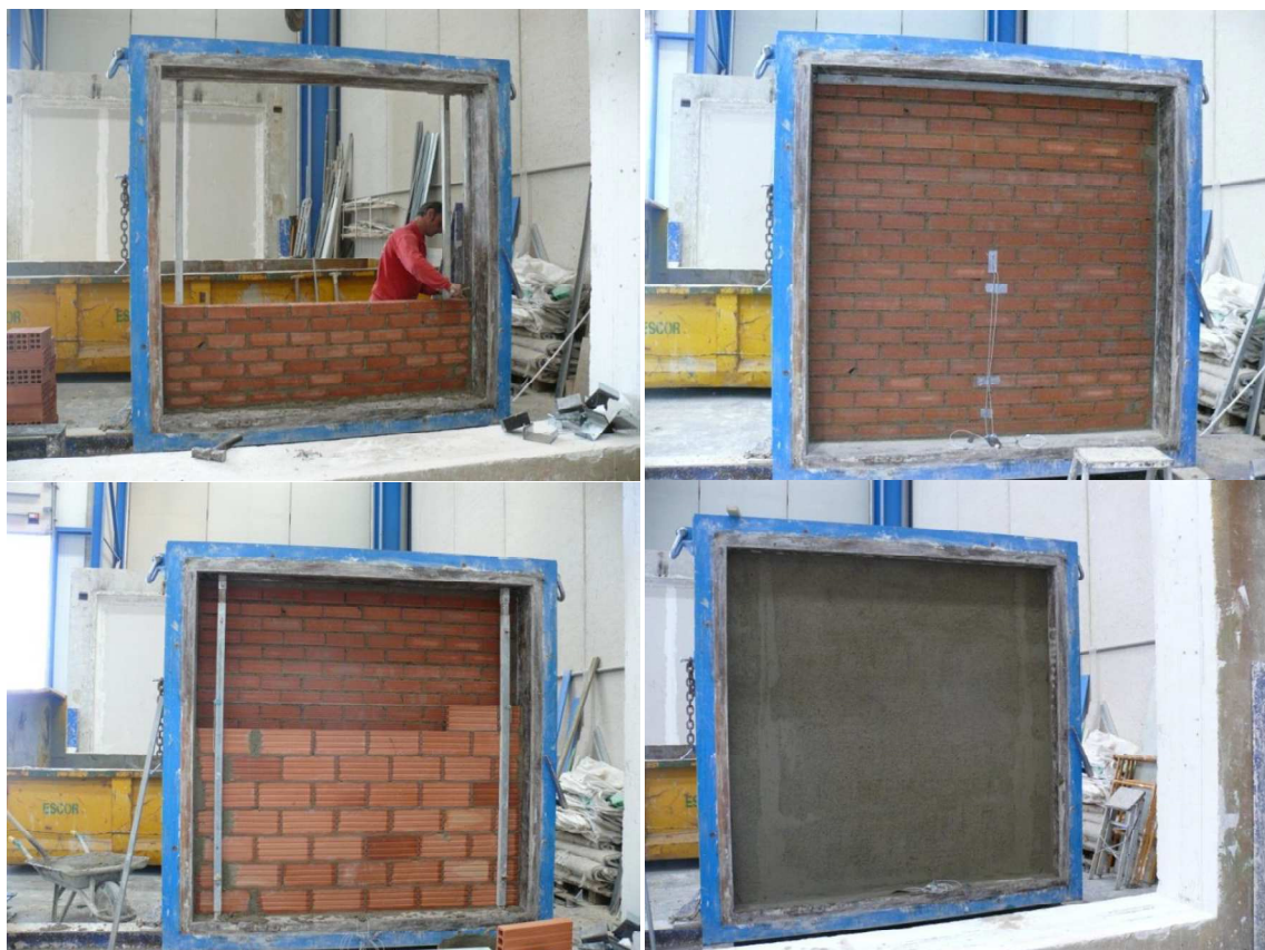
Fig. 3.4. Detalle del levante del ladrillo y raseado del muro base de doble hoja
