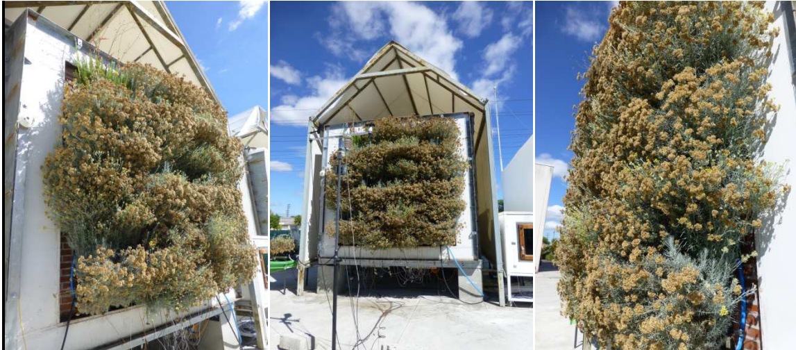
Fig. 4. 32. Detalle de la fachada vegetal en Julio de 2014 durante los ensayo PRBS en la célula de ensayo ILARGI
