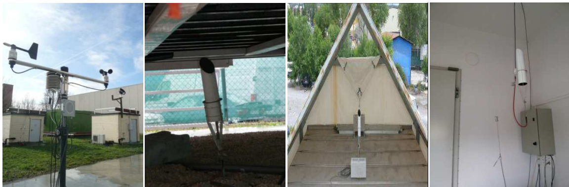
Fig. 3. 23. Detalle de los sensores 2ATE01-2ATE02-2ATE03 y 2ATI09-2STI08
