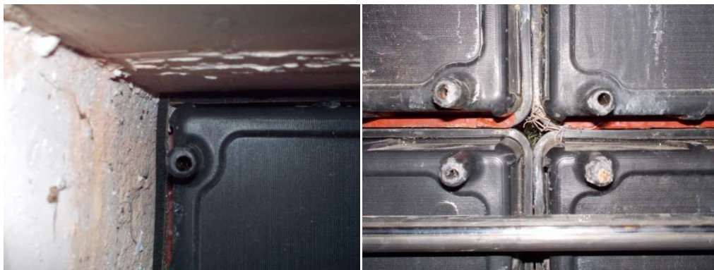
Fig. 6. 2. Izda. Detalle de la unión de los módulos con el marco vertical y horizontal. Dcha. Detalle de la unión entre los módulos.
