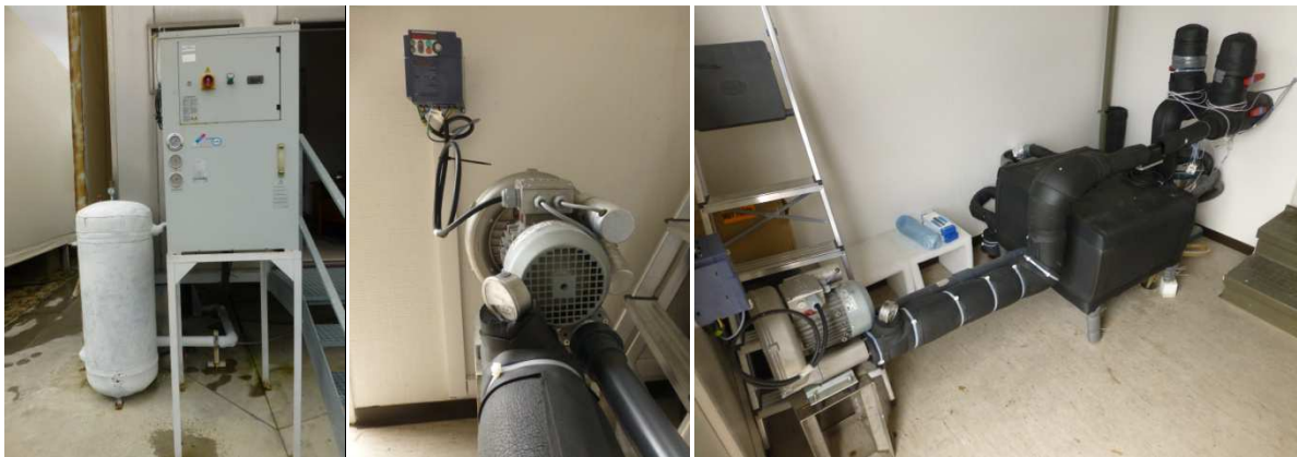
Fig. 4. 51. Izda.: Detalle de la maquina enfriadora y el tanque pulmón. Centro: bomba de aire y variador de frecuencia. Dcha.: intercambiador de calor y válvulas de paso a la celda de ensayo.
