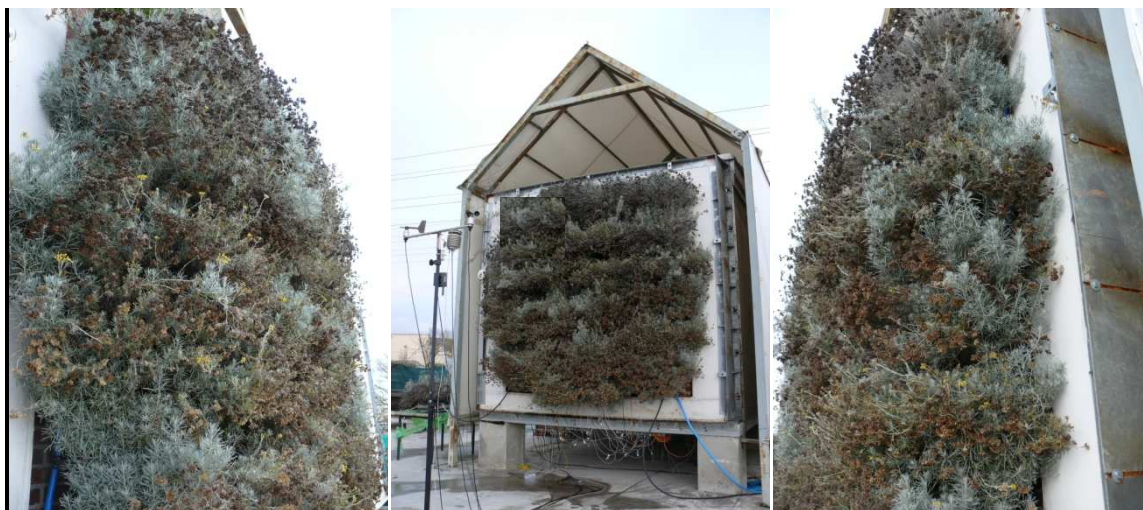
Fig. 4. 35. Detalle de la fachada vegetal en Diciembre de 2014 durante los ensayo PRBS en la célula de ensayo ILARGI
