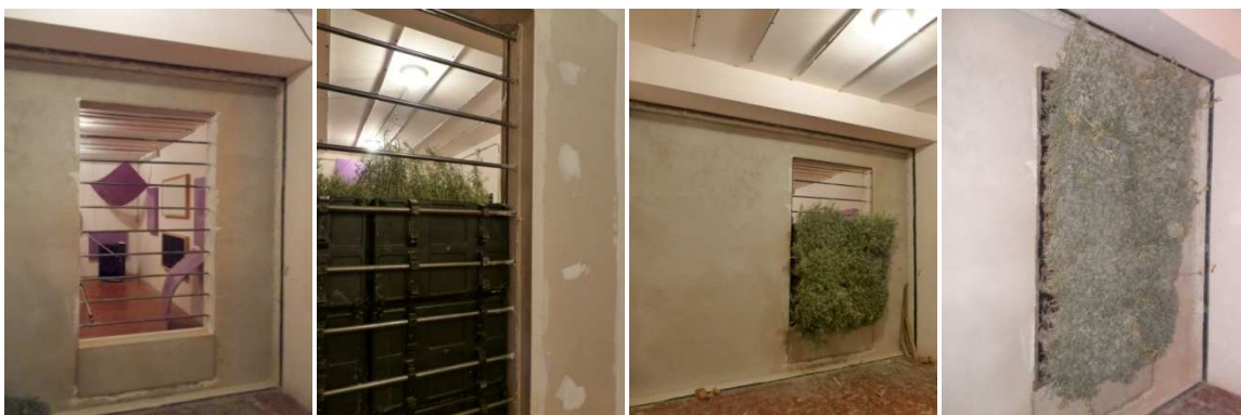
Fig. 6. 3. Resumen fotográfico de la instalación de las muestras para el ensayo de aislamiento acústico.
