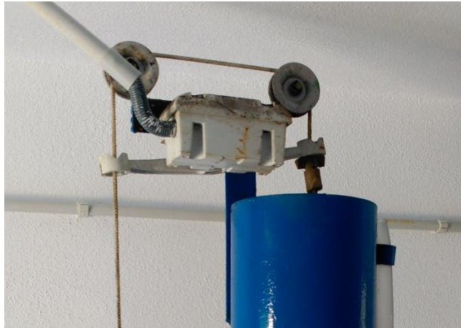
2.4.11. Irudia. Maila kontroleko interruptorea.
