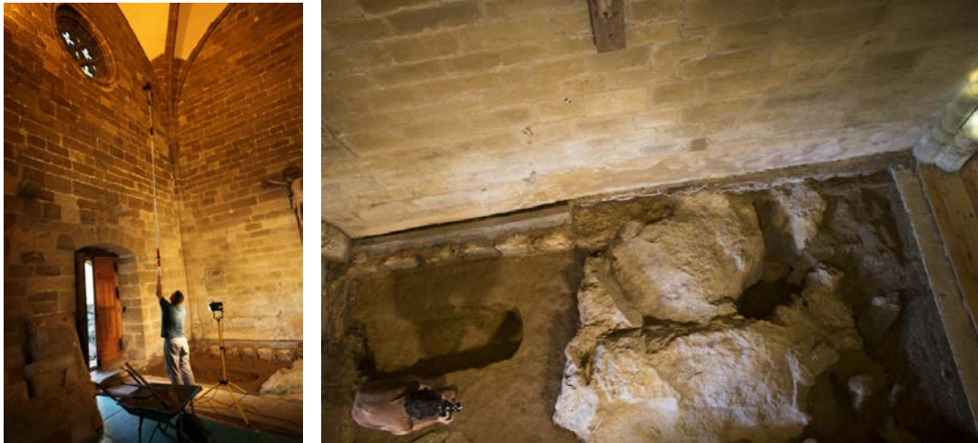
Fig. 7.- En la imagen de la izquierda se presenta una toma mediante jalón telescópico de un detalle situado en un sillar a 4 metros de altura. En la imagen de la derecha se presenta una vista cenital (obtenida también con el jalón telescópico) que muestra un momento de la captura fotográfica para la realización del modelo 3D del sondeo interior.
