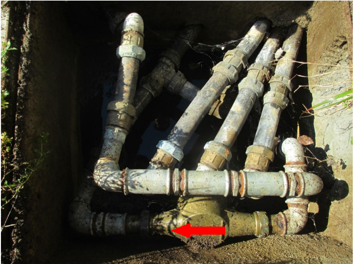
Figura 39. Foto de la instalación original del contador en B21.
