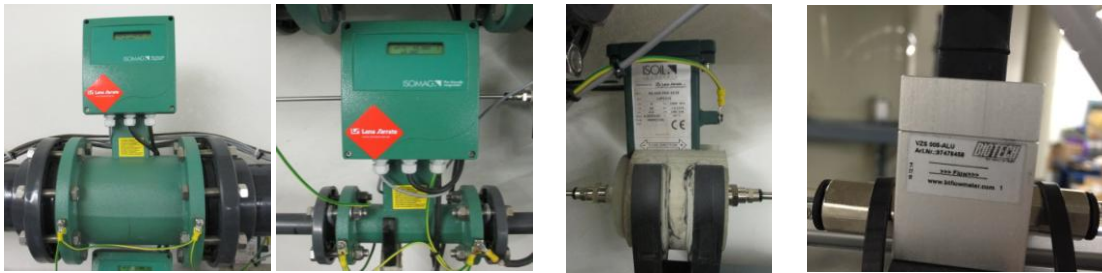
Fotografía 2-15 Medidores de caudal
