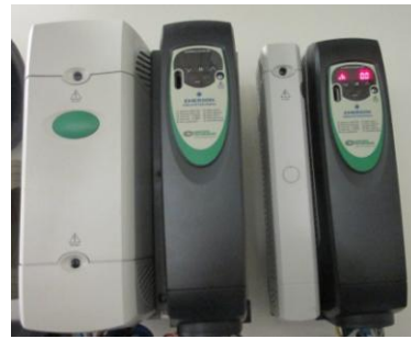
Fotografía 2-6 Variadores de frecuencia de la bomba grande y pequeña, respectivamente
