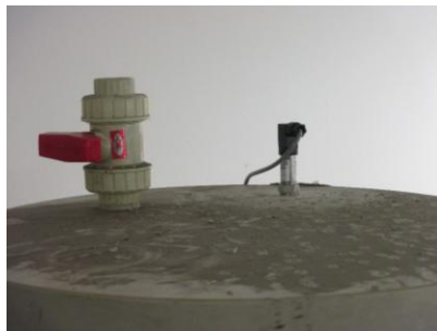
Fotografía 2-20 Transductor de presión depósito sobrepresor
