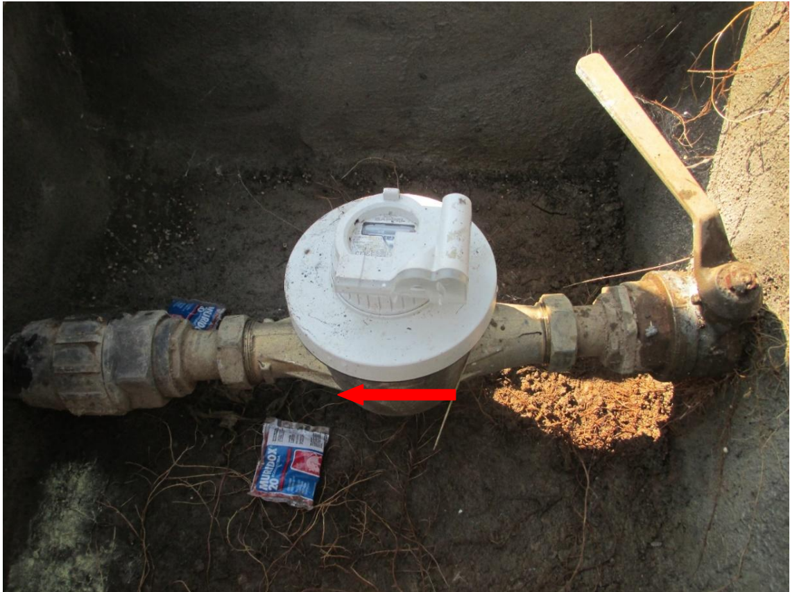
Figura 41. Foto de la instalación original del contador en B24 (EDAR).
