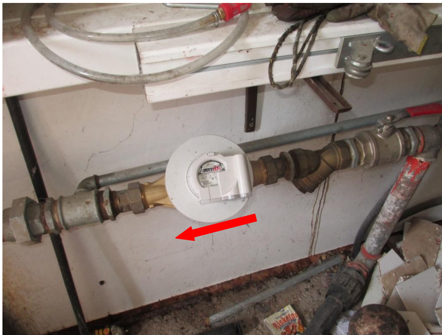
Figura 55. Foto de la instalación original del contador en X19 (Escuela), M-X.
