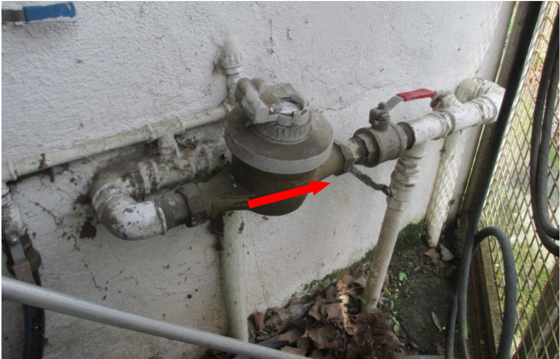
Figura 43. Foto de la instalación original del contador en B26 (Estación de servicio), M-X.
