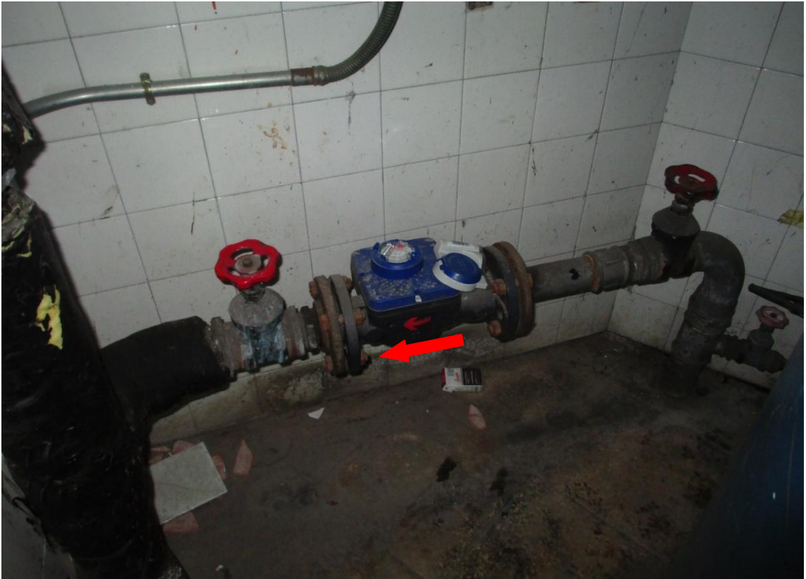
Figura 16. Foto de la instalación original del contador en T17, D.
