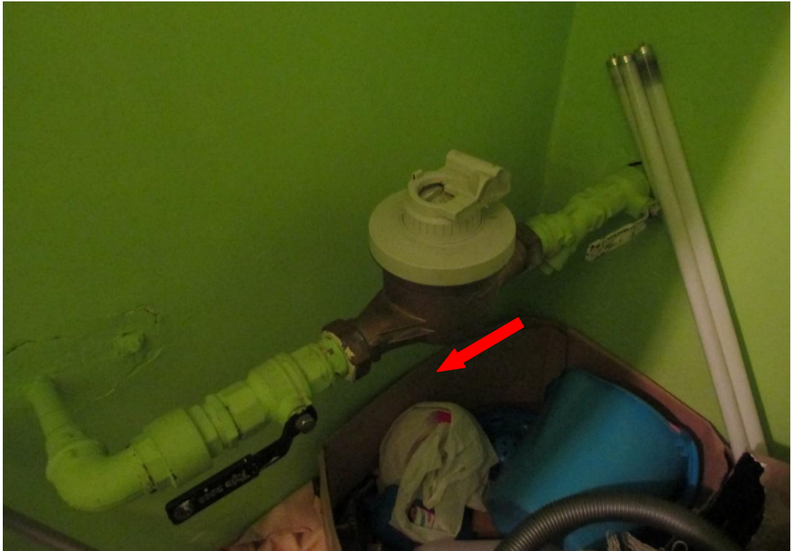
Figura 22. Foto de la instalación original del contador en M10, B.
