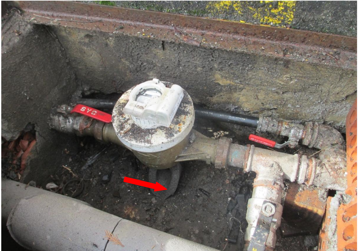
Figura 18. Foto de la instalación original del contador en A19, B.
