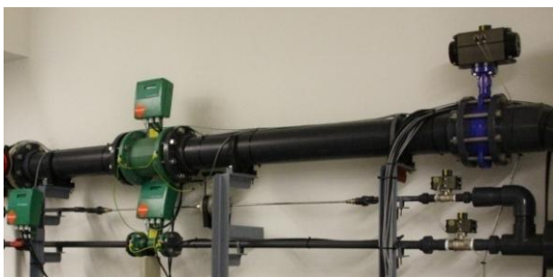
Fotografía 2-13 Válvulas de corte circuitos DN125, DN25 y DN6
