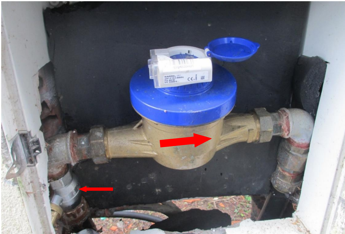
Figura 35. Foto de la instalación original del contador en Z134 (Camping), Z.
