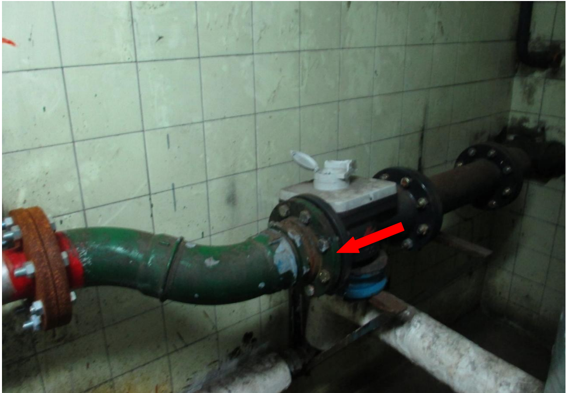
Figura 14. Foto de la instalación original del contador en M3, D.
