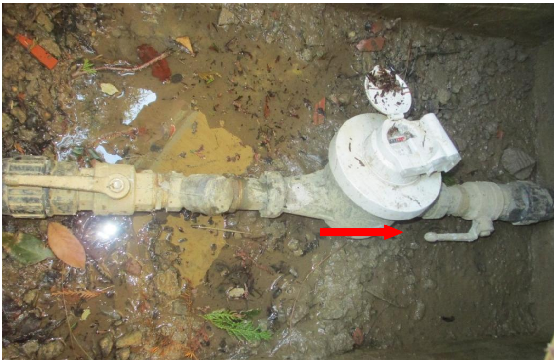
Figura 57. Foto de la instalación original del contador en BL, 30, M.
