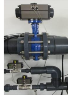
Fotografía 2-12 Válvulas de corte neumáticas, la superior de mariposa y las dos inferiores de bola
