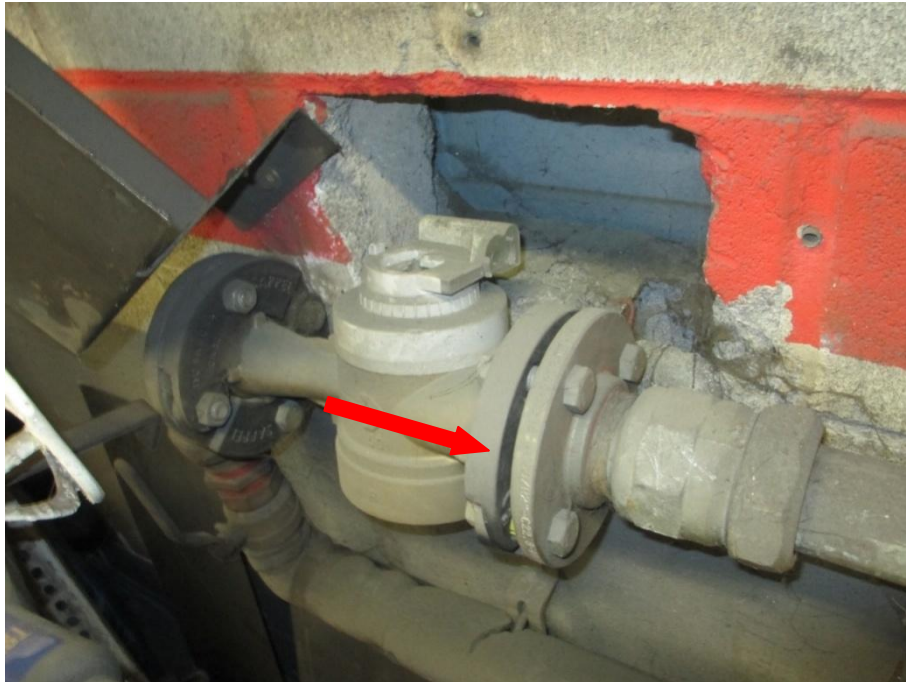
Figura 47. Foto de la instalación original del contador en K11, M-X.
