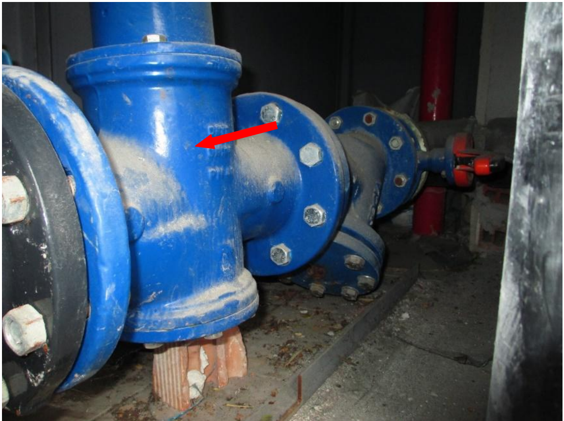
Figura 6. Foto de los elementos hidráulicos del contador en E5, D.
