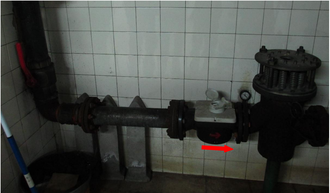
Figura 12. Foto de la instalación original del contador en M1, D.
