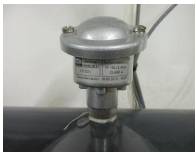
Fotografía 2-1 Sensor de temperatura del agua en circulación
