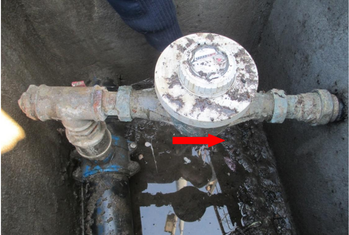
Figura 37. Foto de la instalación original del contador en B20, M-X.
