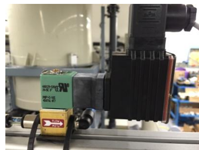
Fotografía 2-14 Válvula de corte DN3
