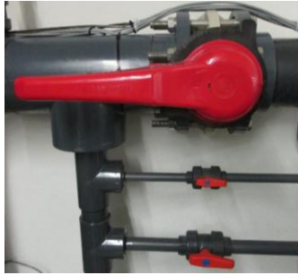
Fotografía 2-11 Válvulas de corte manuales de mariposa la superior y de bola las dos inferiores
