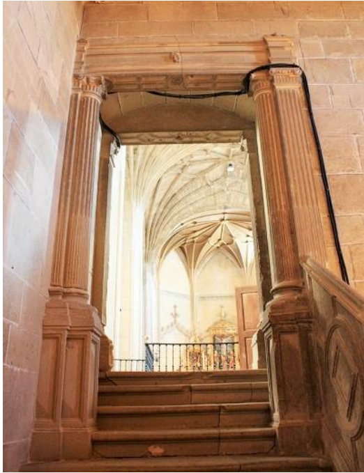
Elvillar. Parroquia de la Asunción. Escalera de subida al coro. Portada de acceso al coro alto
