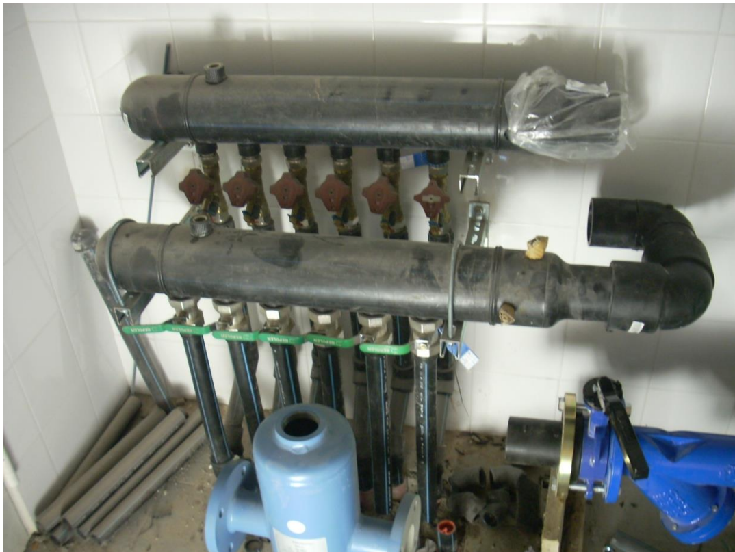
Imagen 15 Extremo del intercambiador geotérmico situado en la sala de máquina (en obras)
