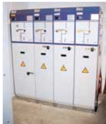
Celdas CGM 36 kV en un PFS
