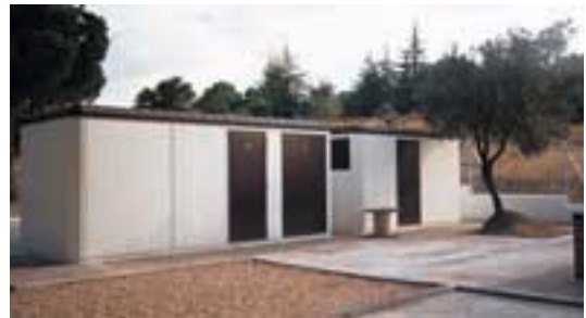
PFU-5 con 1 transformador y PFU-4
