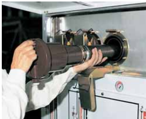
Fusibles CF instalados en una celda de distribución tipo CAS.
