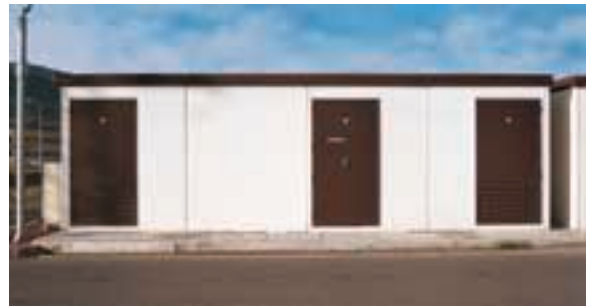
PF-204 con 2 transformadores
