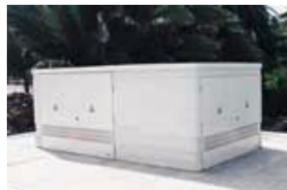
Vista de las puertas de acceso a las celdas CGM y al cuadro de BT en un ORMASET
