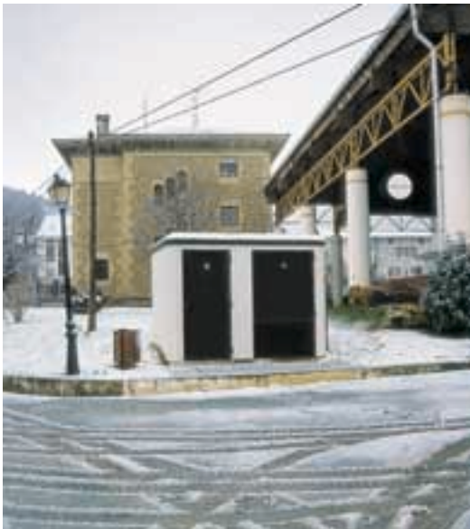
PFU-3 con 1 transformador
