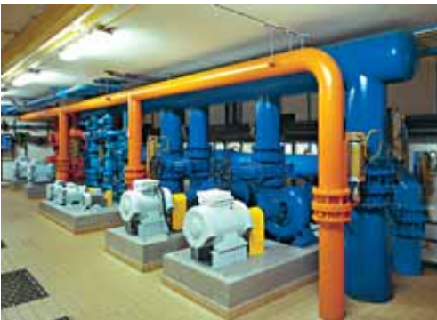
Protección de motores.
