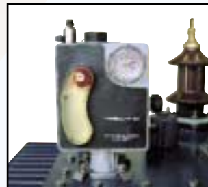
Bloque de Protección y control
