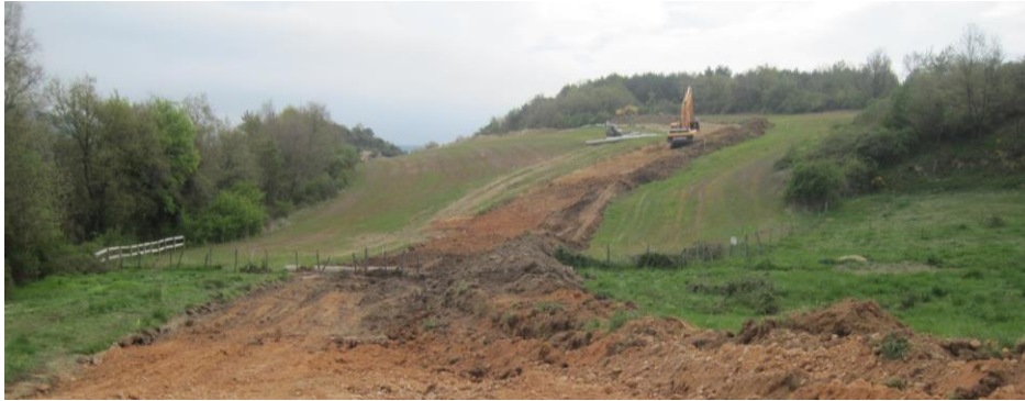
Figura 3.76. Distribución de horizontes en el pedión W363, localizado en una vaguada transversal que desemboca en el Omecillo a la altura del término de La Miel (UTM: X=491.092; Y=4.743.517). La imagen inferior muestra una perspectiva de la zanja hacia el E, que hacia el fondo conecta con una plataforma subestructural.
