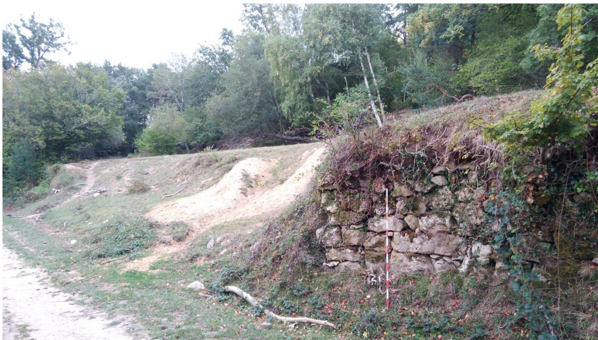
Figura 4.25. Restos de un muro de piedra seca en un salto de bancale en avanzado estado de degradación, localizado en las proximidades de la localidad de Villafría, al pie de los relieves de Árcena.
