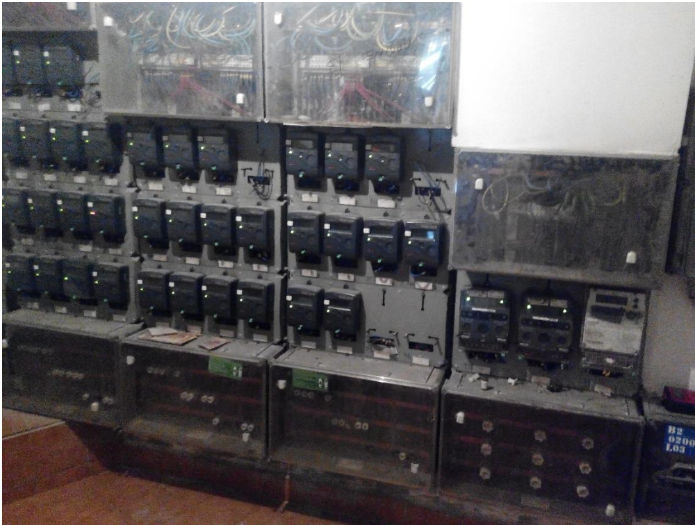
Figura 29: Punto de medida B: Caja de fusibles ubicada en el cuarto de contadores de un edificio residencial
