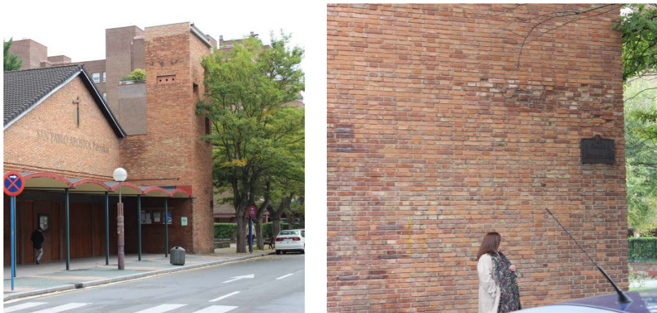
Manchas oscuras y desperfectos en las fachadas, de manera más acusada en la torre. Fotografías de la autora.
