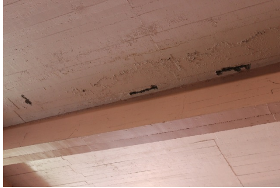
Carbonataciones en el hormigón, vistas desde el interior de la iglesia. Fotografía de la autora.
