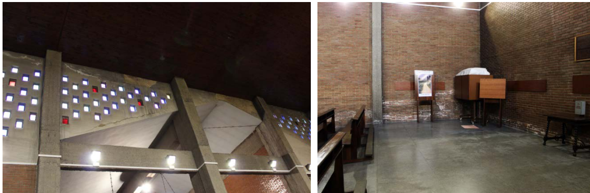
Grieta y manchas de humedad en el cerramiento de hormigón y sales en los muros de ladrillo. Fotografías de la autora.
