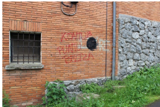
Una pintada denuncia la falta de seguridad en el entorno del edificio. Fotografía de la autora.
