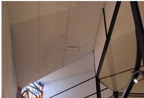
Manchas de humedad formadas por goteras de la cubierta, en la nave principal. Fotografía de la autora.
