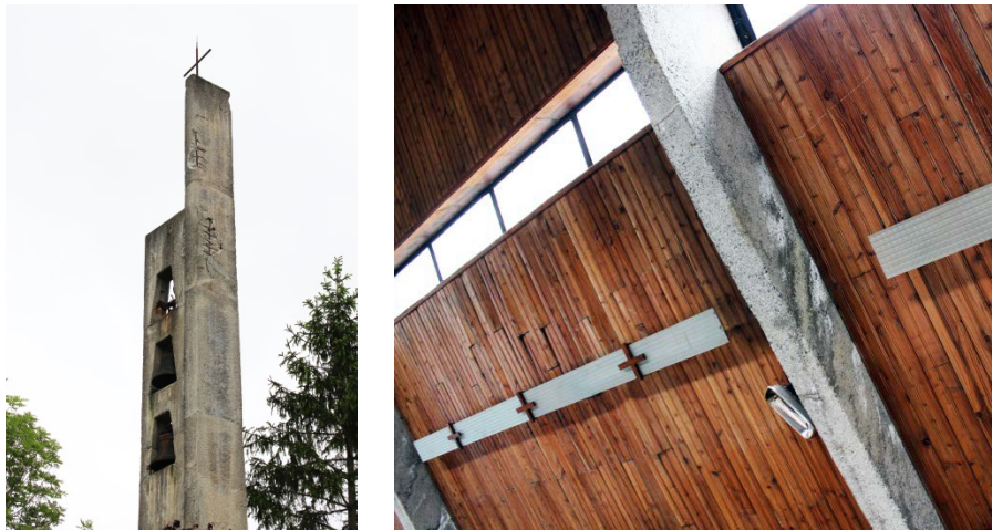
Lesiones en el hormigón: carbonataciones en el campanario y eflorescencias en el interior. Fotografías de la autora.
