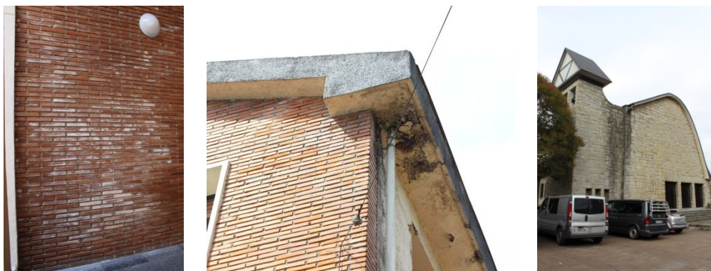
Eflorescencias y problemas de humedad de la iglesia de San Andrés. Fotografías de la autora.
