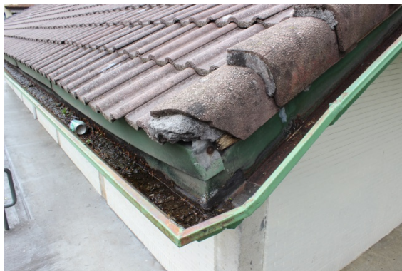
Lesión en la cubierta. Fotografías de la autora.
