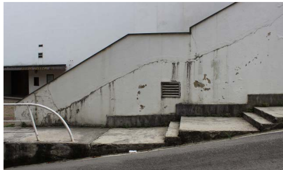
Una de las lesiones exteriores del edificio.
