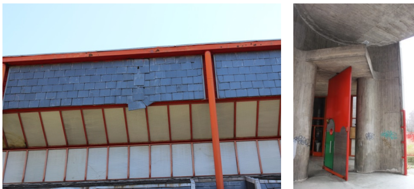
Lesiones exteriores: desprendimiento de tejas (especialmente acusado en los elementos verticales), óxido en piezas metálicas, sales en el hormigón y grafitis.
