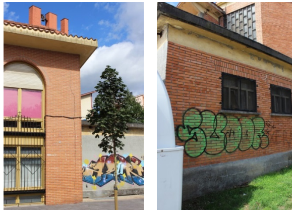
Lesiones exteriores: grieta junto a pilar y grafiti. Fotografías de la autora.
