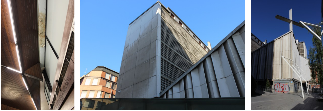
Manchas de humedad interior, piezas oscurecidas en el hastial de una de las alas y grafitis. Fotografías de la autora.
