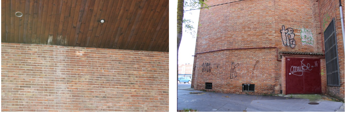
Lesiones en los muros de ladrillo. Fotografías de la autora.
