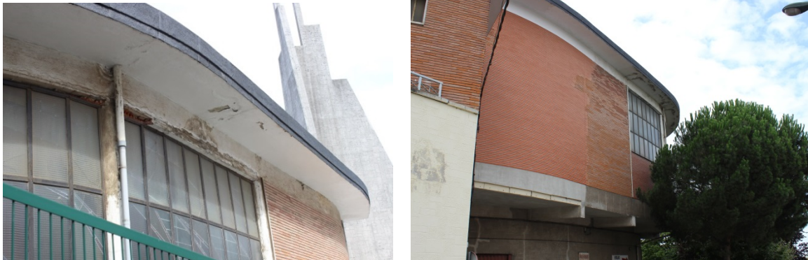
Lesiones exteriores relacionadas con el agua: dinteles en mal estado y muros de fachada que ya han tenido que ser intervenidos.
