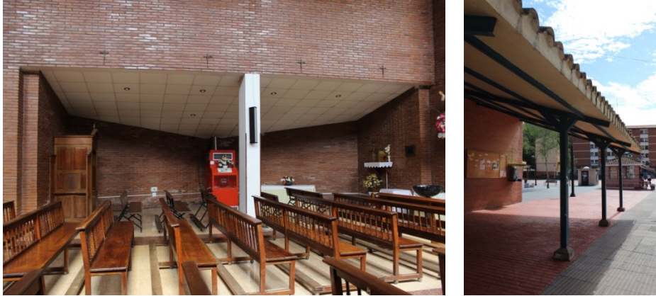
Eflorescencias sobre la antigua capilla y detalle del pórtico de entrada. Fotografías de la autora.
