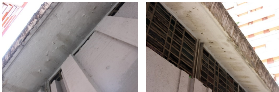
Lesiones en los aleros de la cubierta: manchas de humedad y carbonataciones. Fotografías de la autora.
