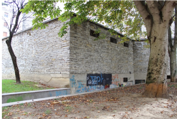
Muestras de vandalismo en una de las fachadas. Fotografías de la autora.
