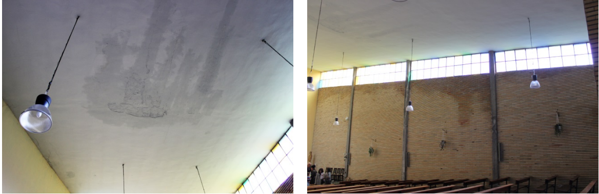
Imágenes de importantes problemas de filtraciones en techo y muros del templo. Fotografías de la autora.
