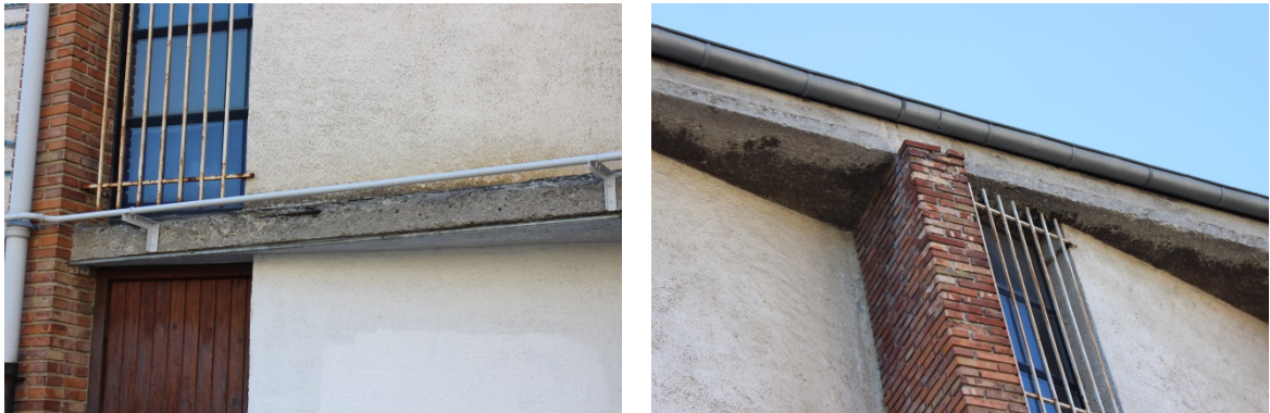
Detalles de lesiones en la fachada norte: carbonataciones, oxidación, humedad y ladrillos en mal estado. Fotografías de la autora.
