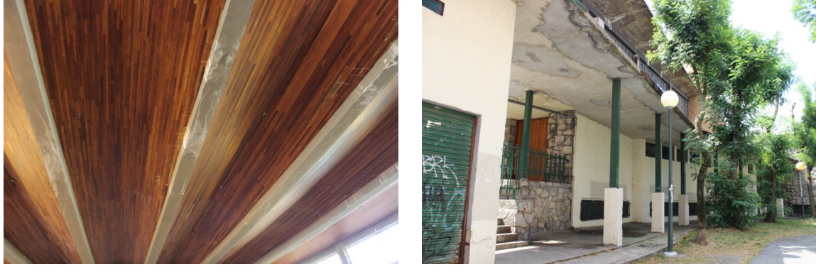
Lesiones en piezas de hormigón. Fotografías de la autora.
