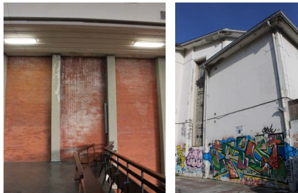
A la derecha, una gran eflorescencia se aprecia en el muro de ladrillo sobre el coro. A la izquierda, una muestra de vandalismo en el exterior de la iglesia.
