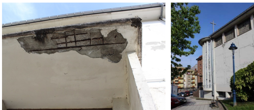
Afectada por la carbonatación, la armadura del porche sobre la entrada lateral al templo está totalmente expuesta (izda.). Desde el exterior el paramento del muro lateral se muestra deteriorado.
