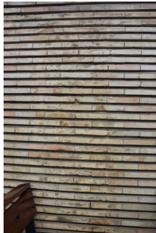
Ladrillos con desperfectos en el interior de la nave principal.
