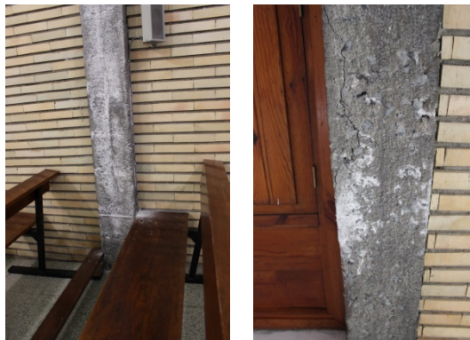
Eflorescencias y grietas asociadas a carbonataciones son las lesiones que afectan a la estructura.. Fotografías de la autora.
