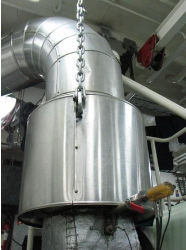
Figura C3- 14. Sonda de TESTO y termopar (tipo K) colocados en el comienzo del conducto de escape del motor principal
