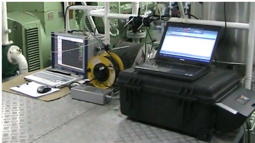
Figura C3- 15. Sistema de adquisición DEWE 2600 (izquierda) y TESTO (Derecha) en la sala de máquinas del buque
