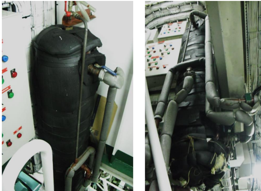
Figura C3- 5. Depósito desgasificador y tubería aislada térmicamente
