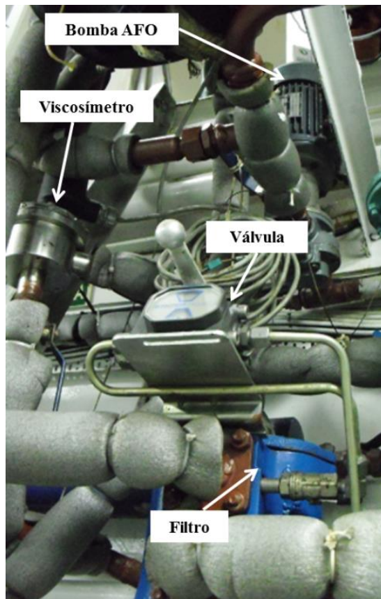
Figura C3- 8. Instrumentación mecánica empleada en el circuito de combustible AFO
