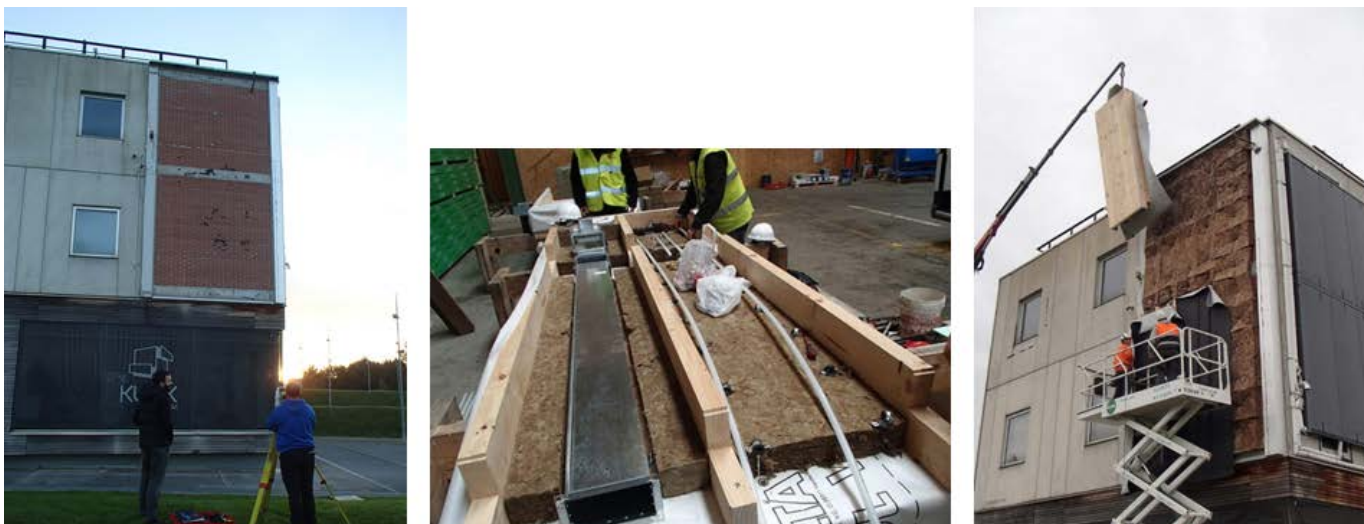
Fig.1. El Proyecto BERTIM se basa en una captura de datos de precisión, diseño digital con la ayuda de la herramienta RenoBIM, fabricación CNC, montaje y rápida instalación de los módulos de madera.
