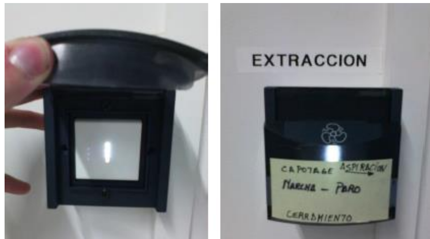
Figura 35. Interruptor de la campana de extracción
