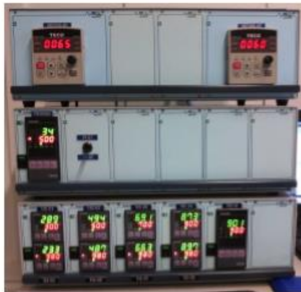
Figura 16. Caja de controladores TOHO de la planta
