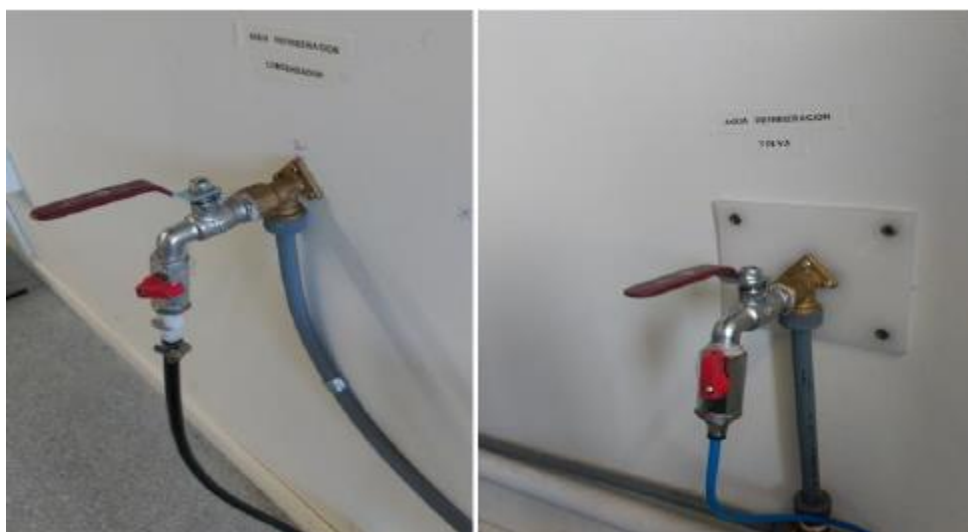
Figura 37. Válvulas del agua de refrigeración del condensador inferior y de la tolva de alimentación Caudalímetro
