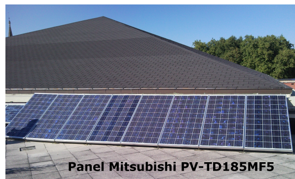
(b) Módulos fotovoltaicos
