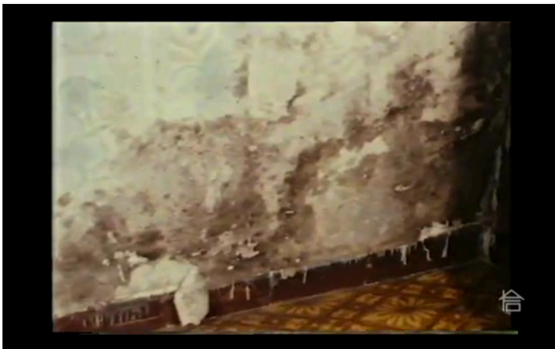
Humedades en el interior de una de las viviendas de Otxarkoaga 375 .
