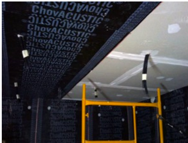
Imagen 27. Lámina viscoelástica instalada.
