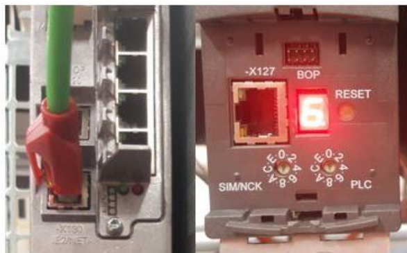
FIGURA 41. PUERTO X130 Y PANEL DE CONTROL DE LA CPU
