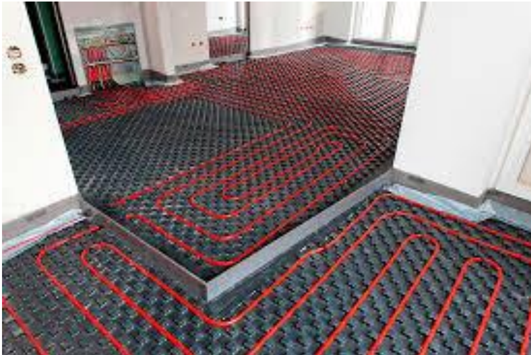
Ilustración 16: Instalación de calefacción de suelo radiante
