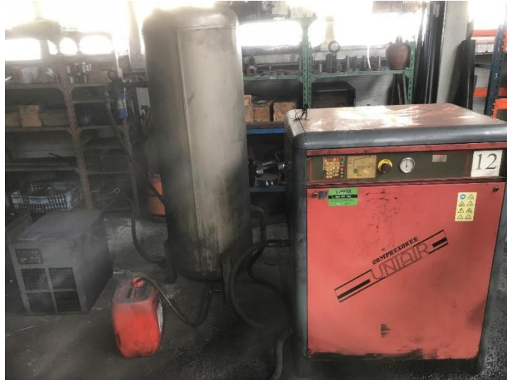
Irudia 47.- Enpresako aire konprimatu instalazioa.
