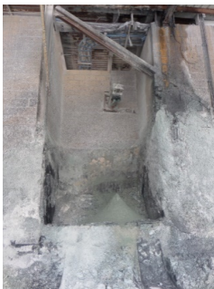
Figura 12 Zona donde se generan los lodos de cal, en la empresa papelera Smurfit Kappa Nervion S.A.
