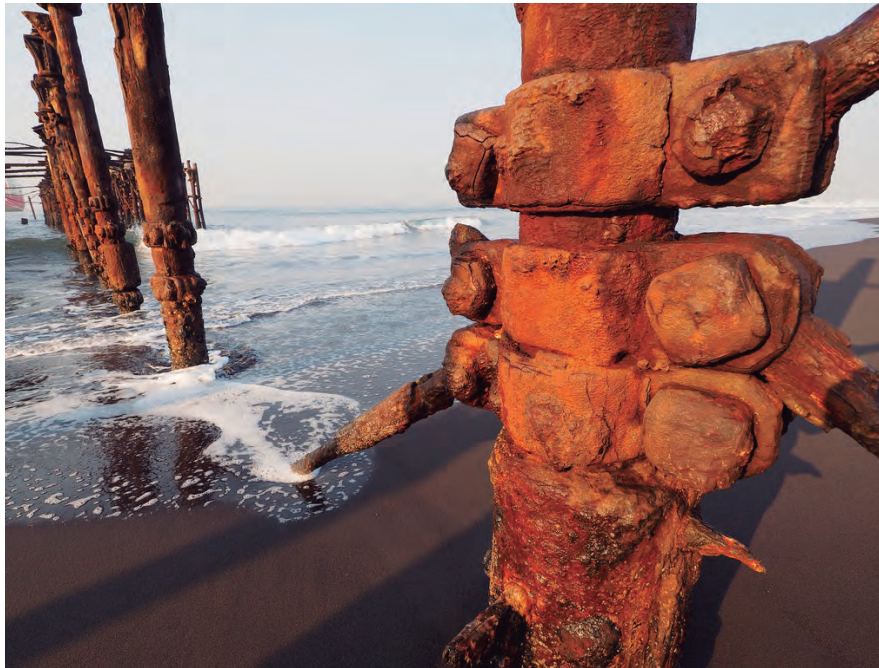
Herrumbre en plataformas marinas.
