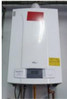
Imagen 13: Caldera de condensación Baxi-Roca.
