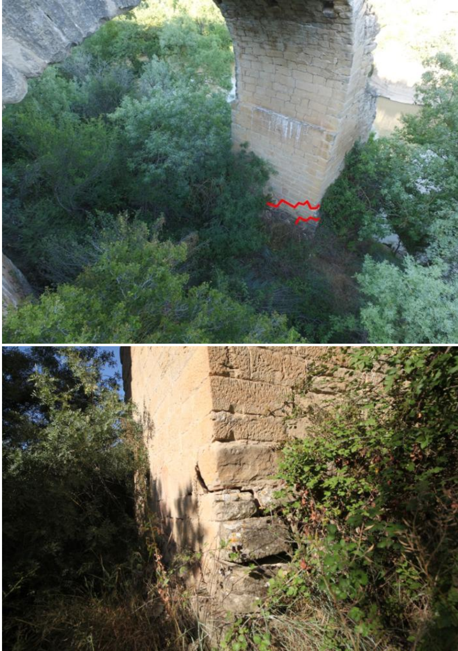
Fig. 36.- Fracturas diagonales en la parte trasera del interior del pilar junto al río.
