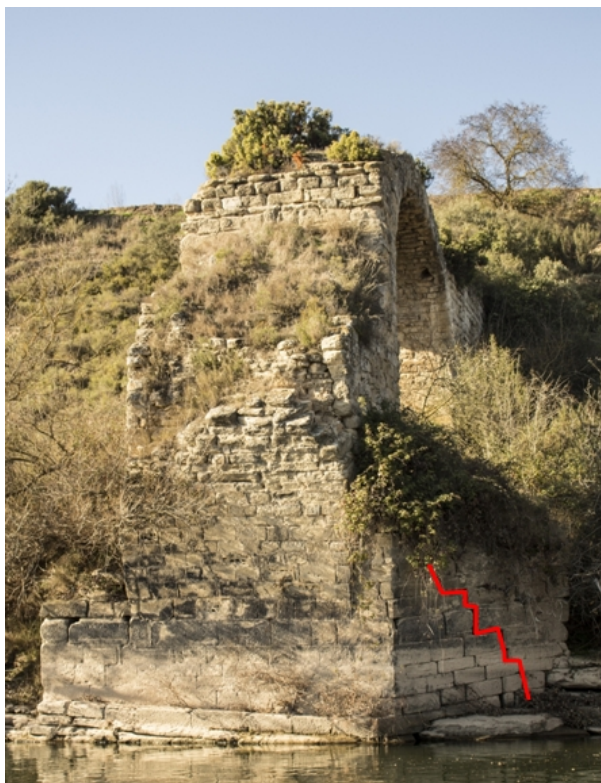
Fig. 39.- Grieta visible en la pared del tajamar.
