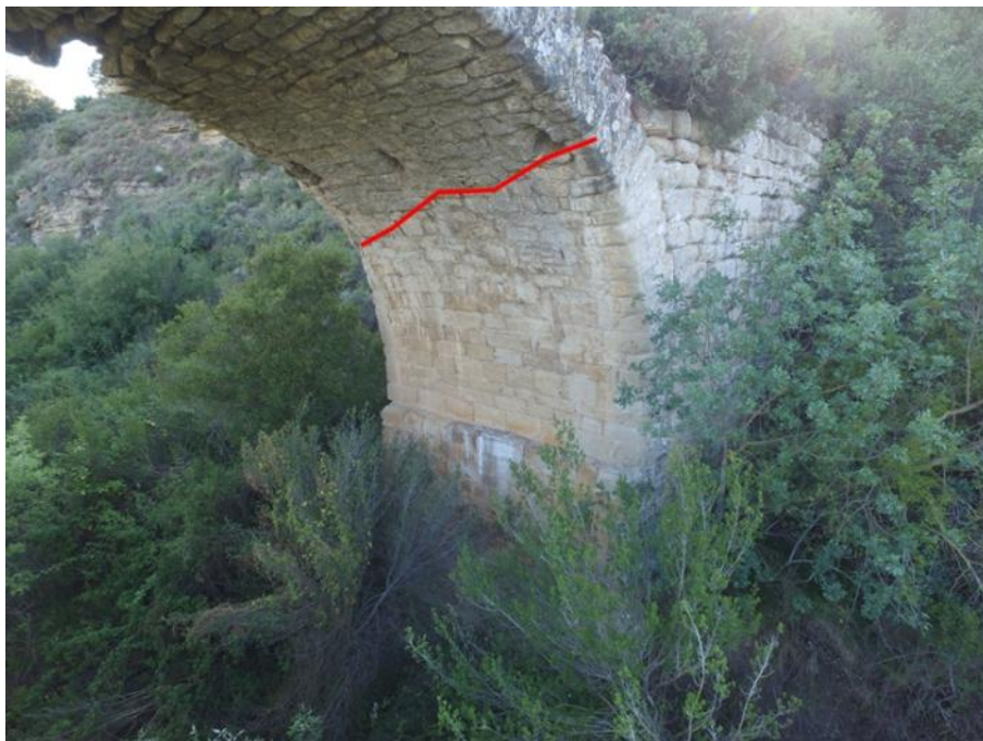
Fig. 38.- Grieta de desarrollo diagonal junto al estribo.
