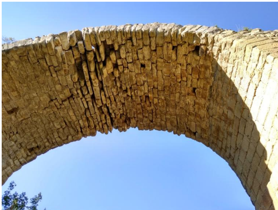
Fig. 3.- Aspecto del arco de la margen riojana en julio de 2017. Nótese la falta de piezas en la parte central del arco y que incluso existen huecos que permiten ver el cielo a través.
