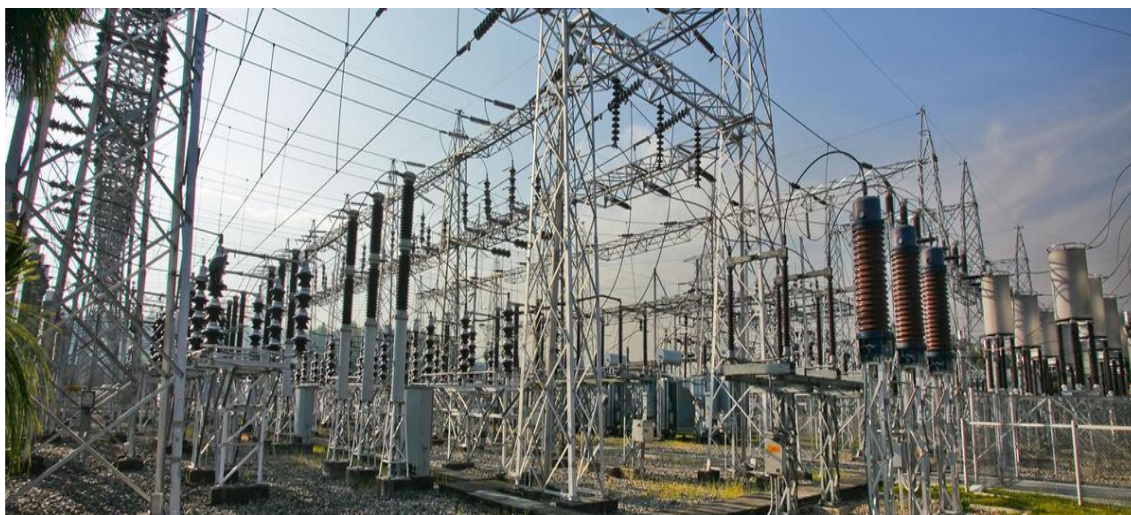
32. Irudia. Goi tentsioko elektrizitatea lortzeko azpiestazio elektrikoa [17].
