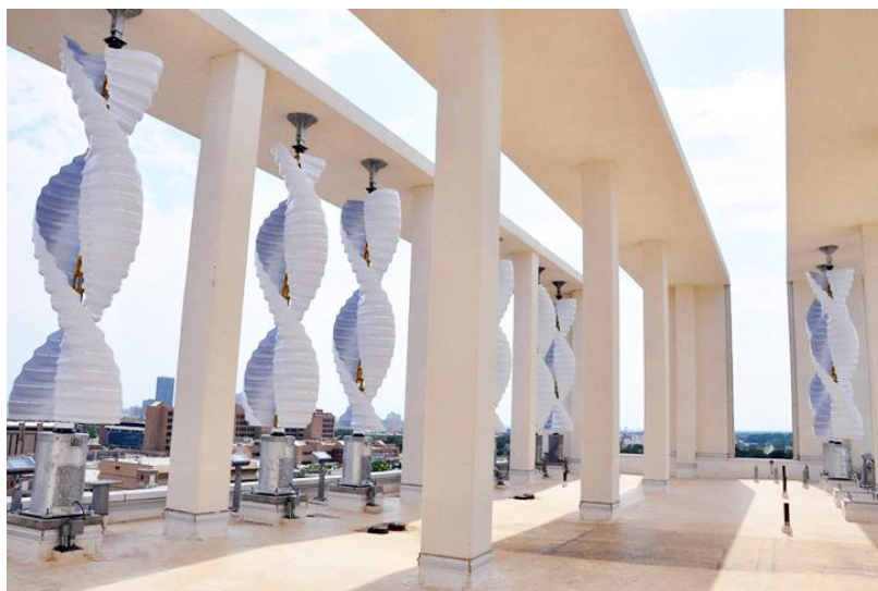
Ilustración 7. Instalación de turbinas Venger Wind en el tejado de un edificio.
