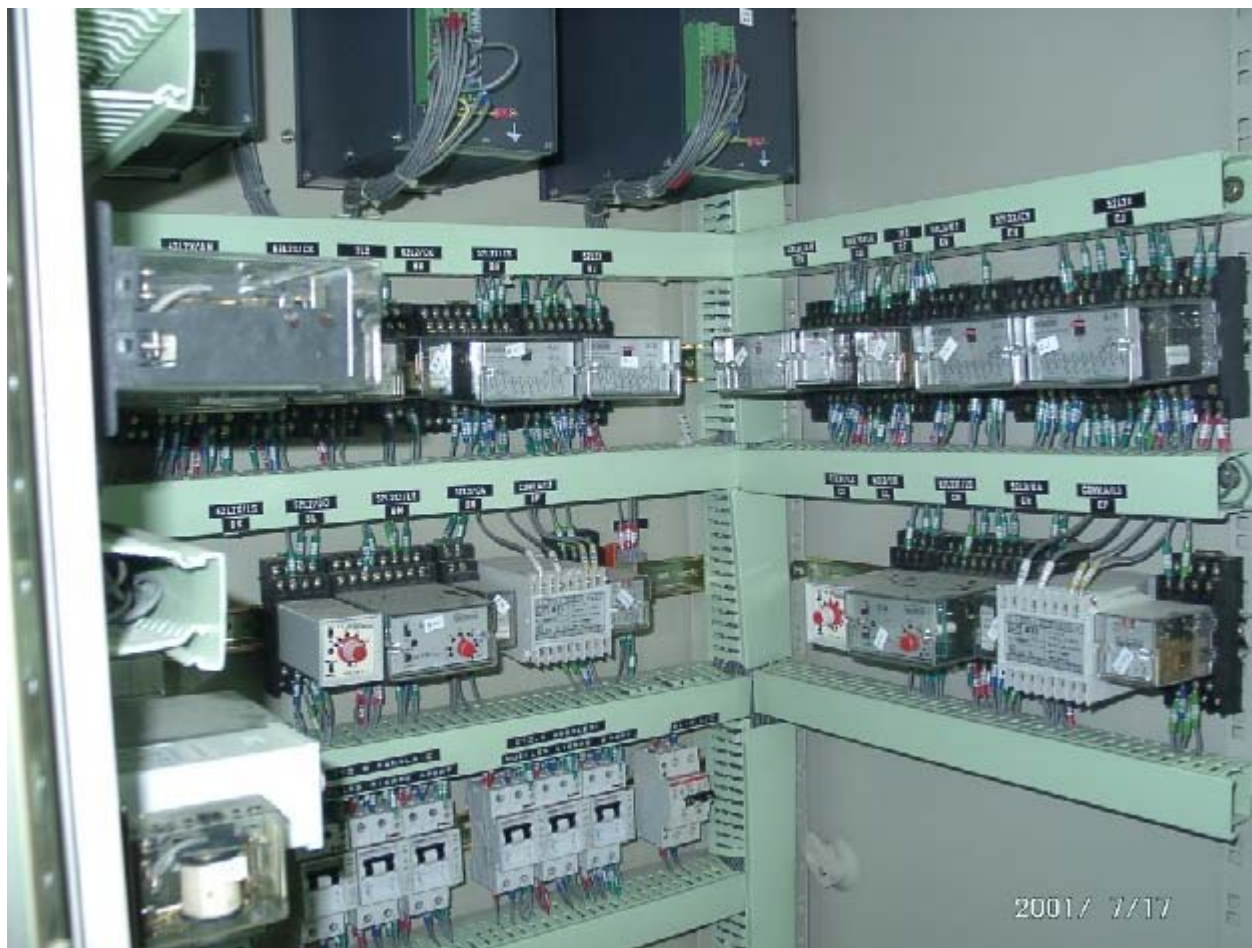
CELDA DE PROTECCIÓN - VISTA INTERIOR
