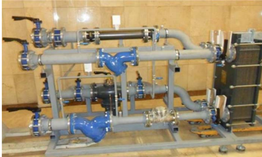
Ilustración 27: Intercambiador de calor de la subestación térmica
