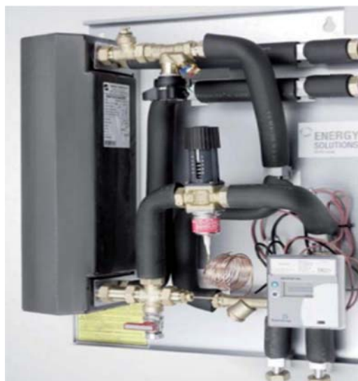
Ilustración 28: Subestación de calor para una vivienda
