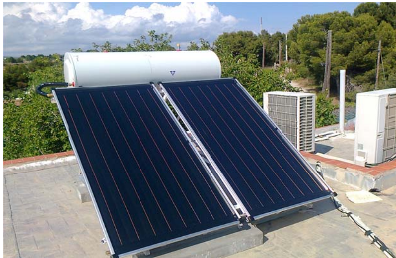
Ilustración 11: Sistema de captación solar de Baja Temperatura
