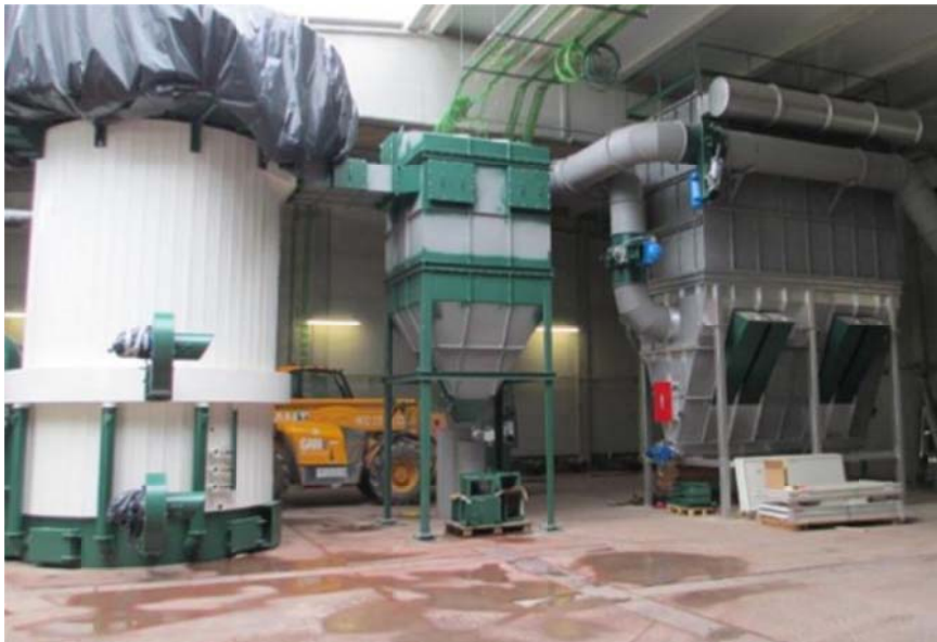
Ilustración 22: Caldera, sistema multi-ciclónico y filtro de mangas
