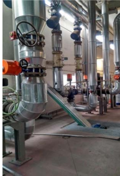
Ilustración 24: Sistema de bombeo del circuito primario de cada caldera
