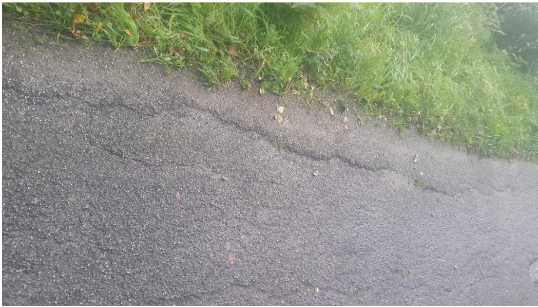
Indicios de derrumbamientos en la vía de acceso al faro.
