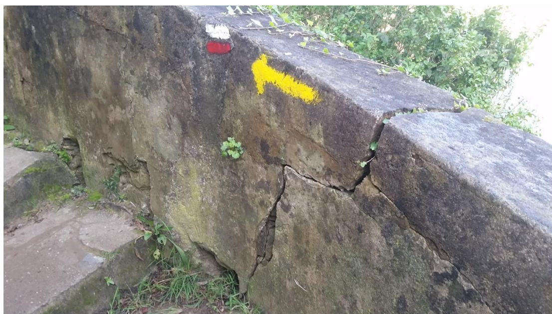
Indicios de derrumbamientos en zona peatonal.
