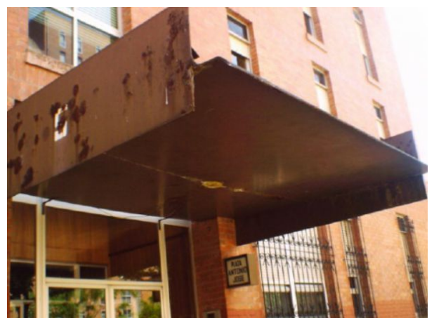
Ilustración 32. Marquesina metálica con signos de oxidación
