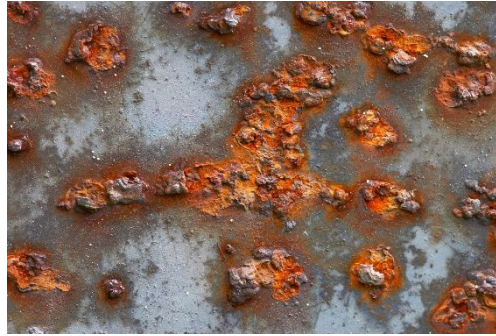
Ilustración 33. Corrosión localizada en acero ( http://cort.as/-LEvl )
