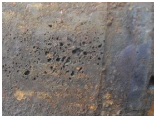
Ilustración 34. Corrosión por picadura en aluminio (blog, 2016)
