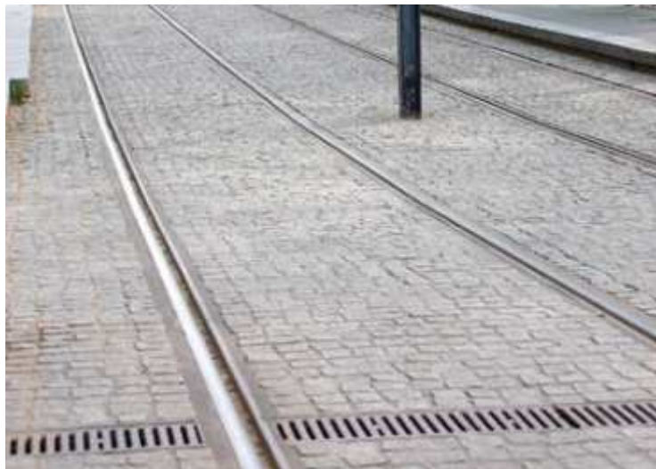
Imagen 17: Ejemplo de canal de drenaje
