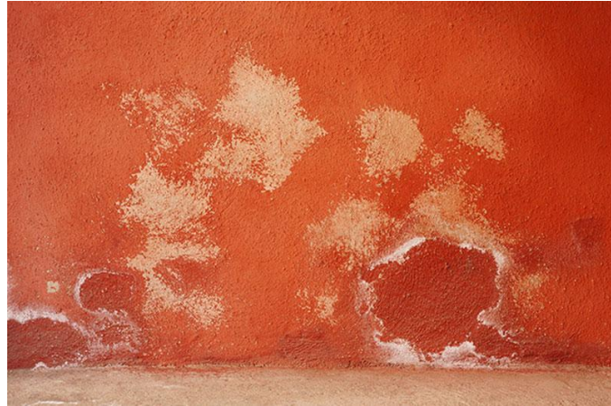
Figura 2 Pared mostrando serios daños por la eflorescencia salina.
