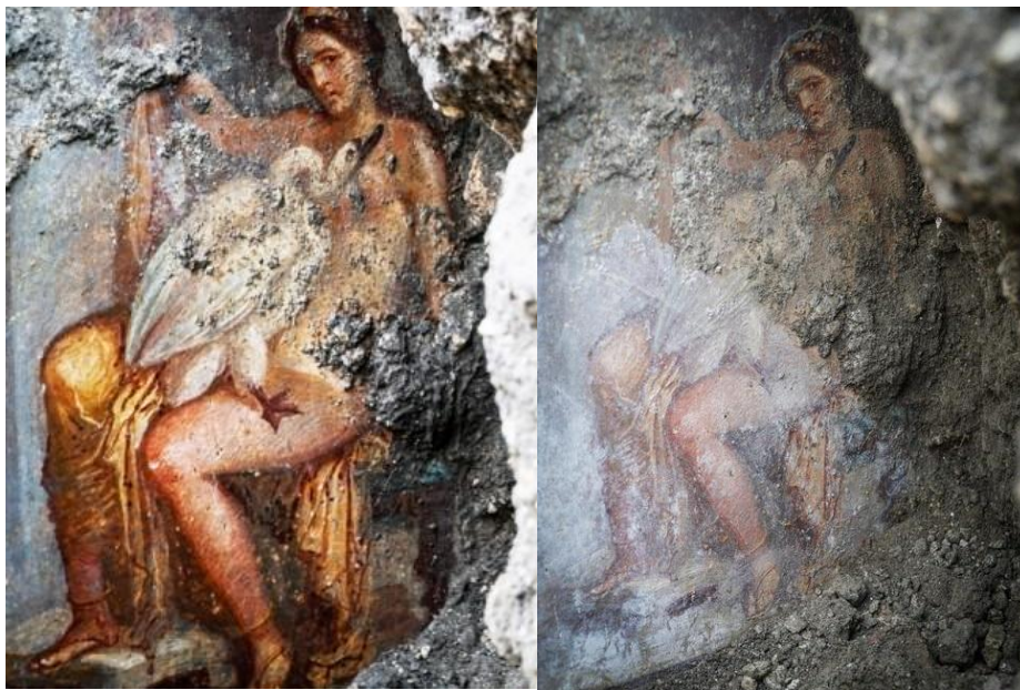
Figura 5 Fresco de “Leda y el Cisne” con visibles marcas de eflorescencia salina tras varios días al contacto con el exterior.
