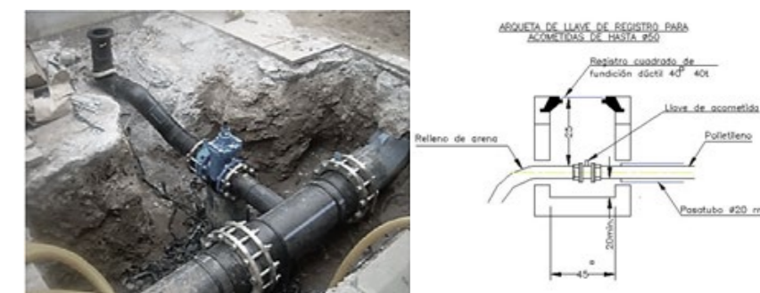
Ilustración 26: Arqueta del edificio:
