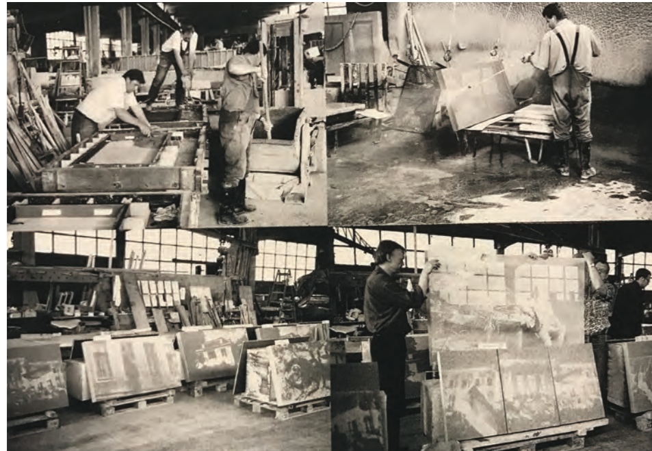
Elaboración de los prefabricados de hormigón, una lámina impresa con retardadores del fraguado se coloca en el encofrado, para posteriormente lavar la lechada superficial revelando la imagen digital trasladada a las piezas de fachada.
