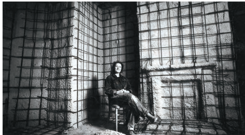
La artista Rachel Whiteread en el interior del salón de la villa original, ya preparada para asumir el vertido de hormigón en masa que rellenaría sus espacios interiores. Pueden verse las paredes gunitadas para cerrar cualquier hueco y garantizar la planidad del acabado final, así como las mallas de armado metálico que mantendrán la cohesión de la masa de hormigón.
