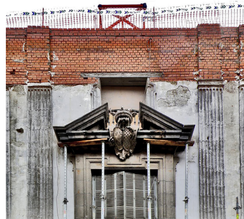
Estado de abandono Tareas de cubierta del palacio, 2003.
